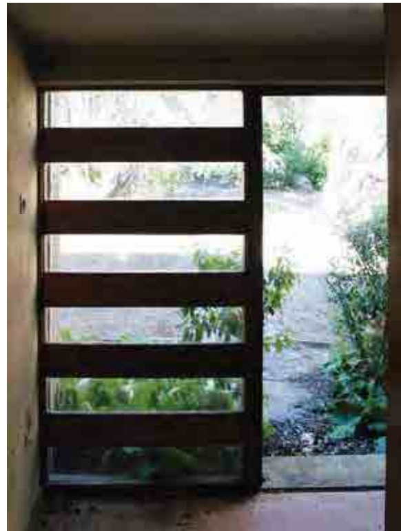
Presa de Picote. Casa para personal dirigente. Vista interior del acceso. Fotog. Ricardo Merí.
