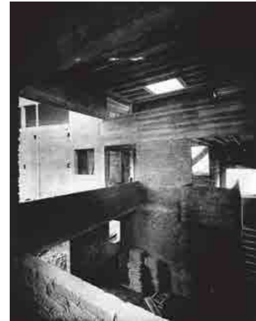
Casa La Roche. Fotografía de la casa durante las obras. Extraída del libro Le Corbusier le Grand .
