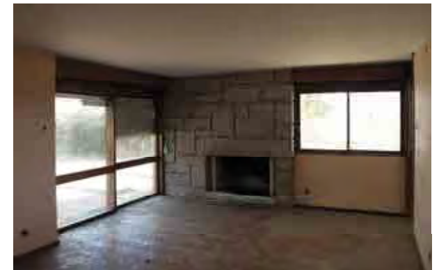
Presa de Picote. Casa para personal dirigente. Vista interior de la sala. Fotog. Ricardo Meri.
