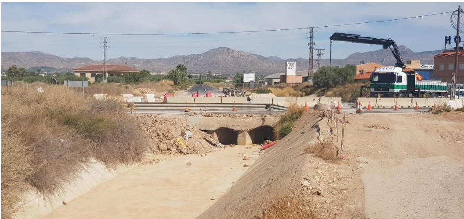
Figura 3. Reconstrucción que se está llevando a cabo sobre un vial afectado por la crecida de la Rambla Salada de 2019. FUENTE: Elaboración propia.
