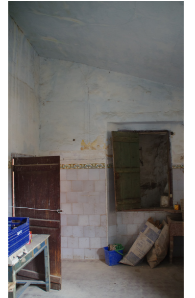
Fig. 6: Pozo en la cocina
