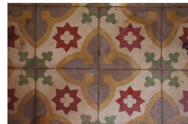
Fig. 3: Pavimento hidráulico dormitorio 2
