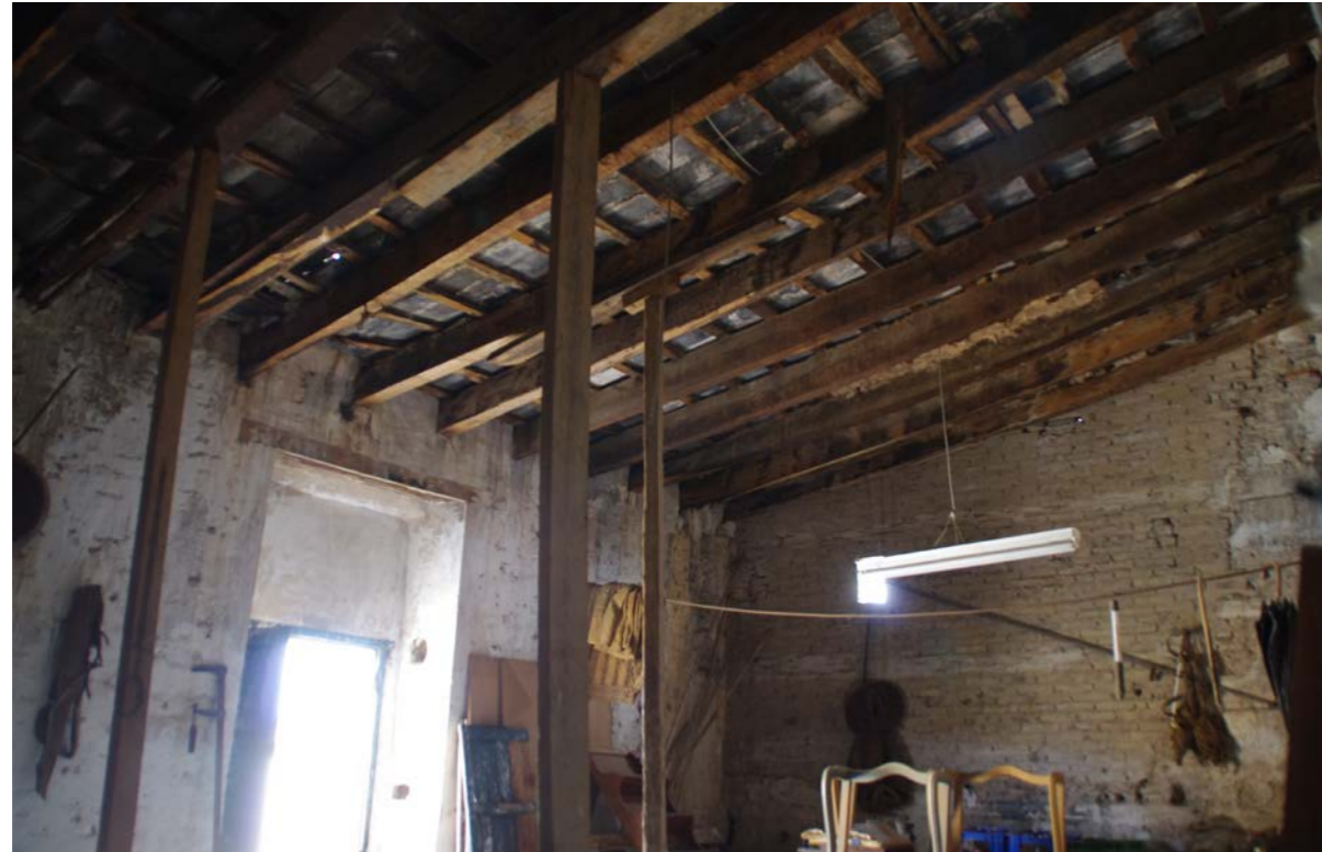
Fig. 20: Correas apuntaladas desde la alcoba de la planta superior
