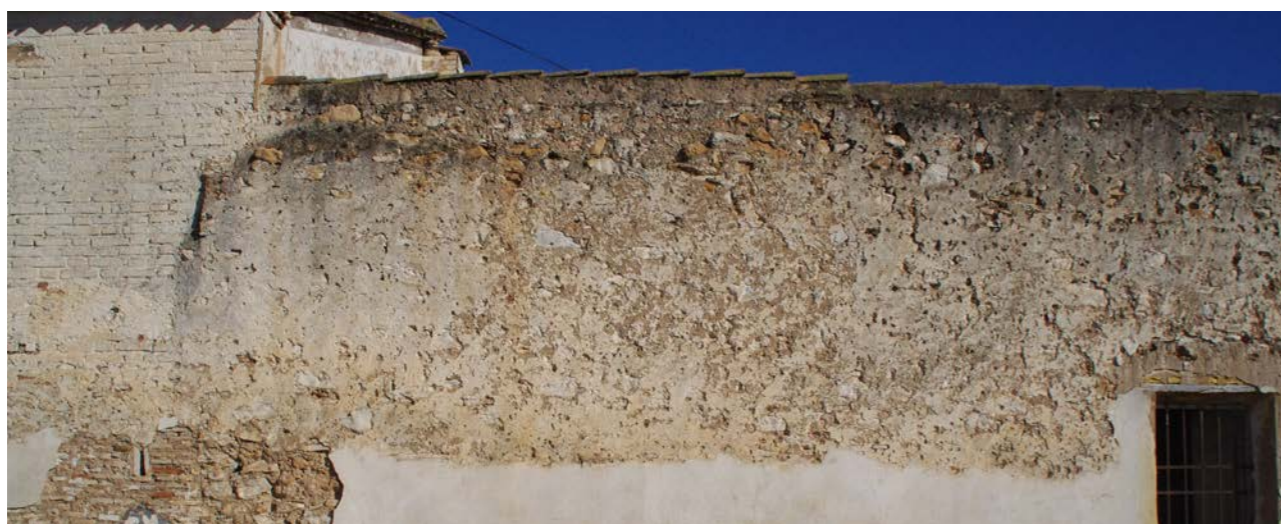
Fig. 1 y 2: Fachadas principal y posterior en gran deterioro
