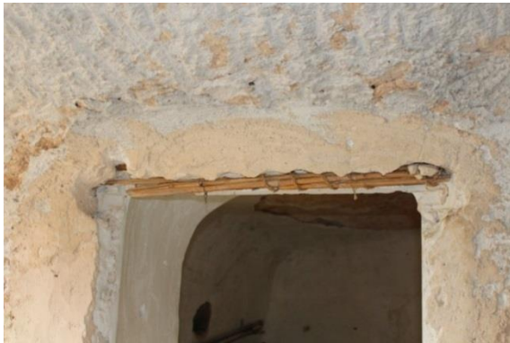
Figura 261. Dintel en hueco de paso interior realizado con cañas y yeso. Cueva 03_04_59 de Hondón de las Nieves
