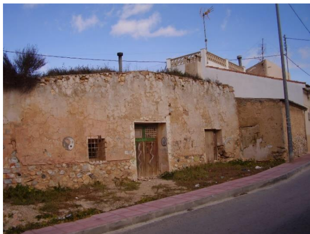
Figura 386. Desprendimiento de revestimiento por filtración de agua. Cueva 11_03_13 de Monóvar
