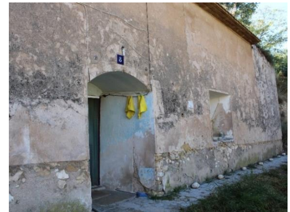
Figura 400. Deterioro y pérdida del acabado de pintura en la superficie. Cueva 17_01_04 de Monóvar
