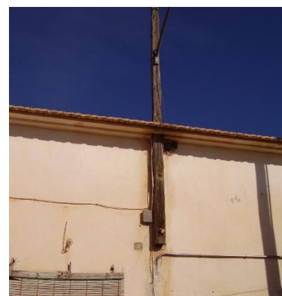
Figura 406. Apoyo de red eléctrica empotrado en cubierta de cueva y anclado a antepecho. Cueva 04_01_01 de La Romana
