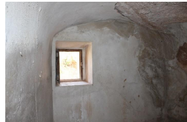
Figura 384. Filtraciones desde encuentro entre cubierta y antepecho. Cueva 05_01_06 de La Romana
