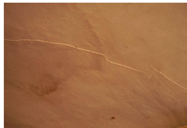
Figura 374. Grieta vertical en esquina. Cueva 05_01_06 de La Romana
