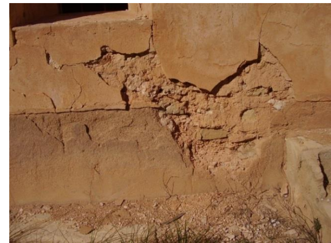
Figura 388. Pérdida de parte del revestimiento exterior. Cueva 03_04_73 de Hondón de las Nieves
