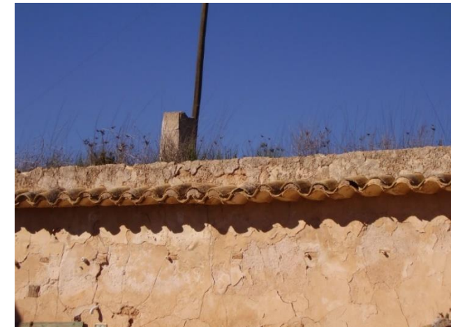
Figura 207. Remate de antepecho con teja curva. Cueva 03_04_76 de Hondón de las Nieves
