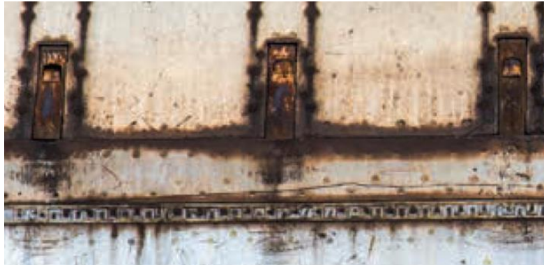
Imagen Nº 4: Piezas metálicas de un puente corroídas por la acción mecánica de las cargas.
