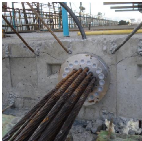
Imagen Nº 5: Cables de acero tensados y anclados al hormigón con presencia de corrosión.
