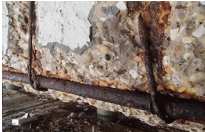
Imagen Nº 1: Corrosión severa de las armaduras de una viga
