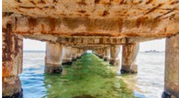
Imagen Nº 9: Muelle con armaduras visibles como consecuencia del desprendimiento del recubrimiento
