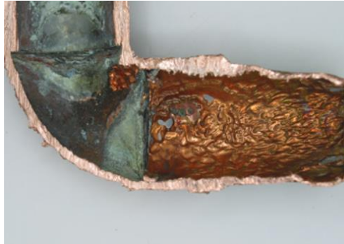
Imagen Nº 6: Tubería con corrosión interna por erosión.
