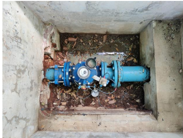
Figura 8 Válvula con caudalímetro. Fuente: red hidráulica
