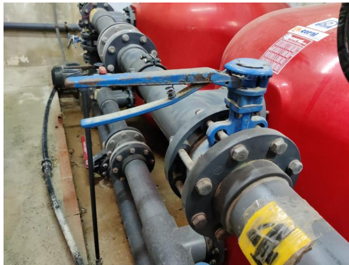
Figura 7 Válvula 2. Fuente: red hidráulica
