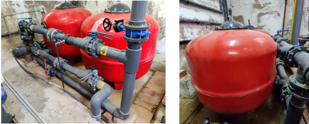
Figura 10 Filtros de arena. Fuente: red hidráulica
