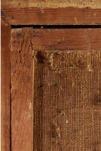
Figura 26. Manchas de hongos.
