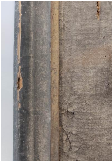
Figura 35. Pérdida de madera en el marco.
