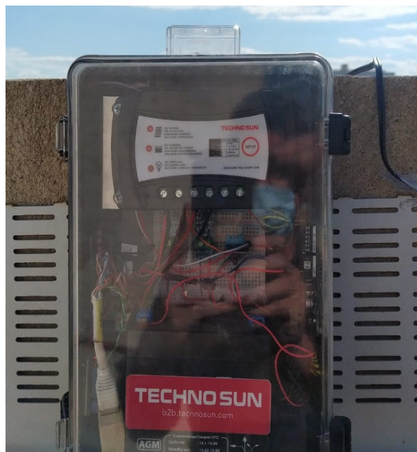
Figura 9: Caja de sensores instalada.
