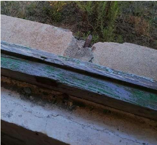
Figura 62: Surco para recoger el agua de condensación al interior de la carpintería y canalizado al exterior a través de un tubo metálico. (Senín, 2021)
