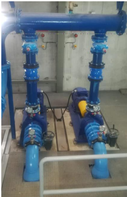
Figura 27. Estación de bombeo del subsistema a optimizar.
