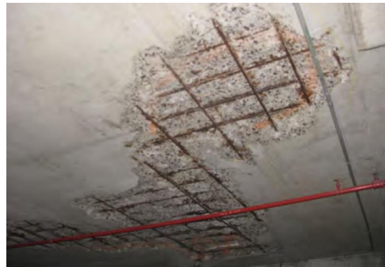
Fig. 24. Detalle de la corrosión de la armadura de acero.
