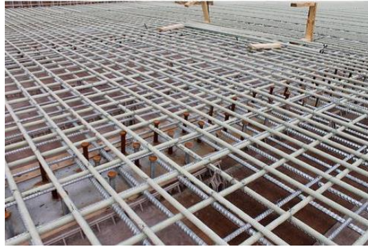
Fig. 29. Armado híbrido losas. Acero galvanizado en la cara inferior y GFRP en la superior.
