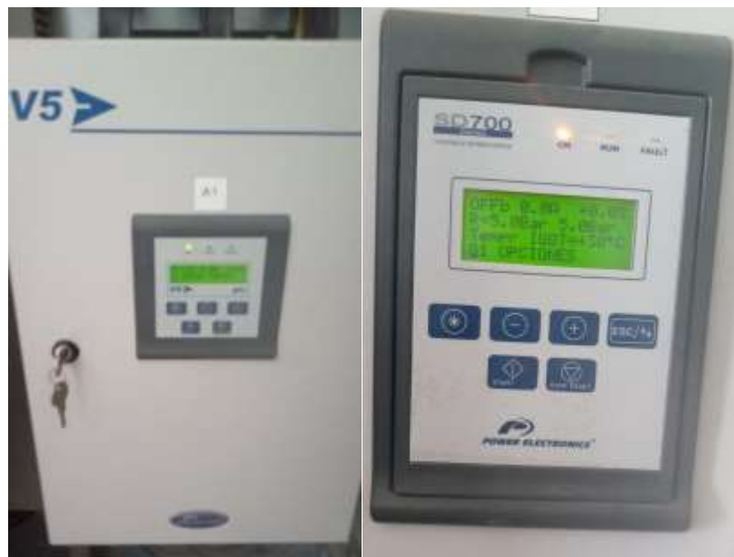
Figura 6. Variador existente. SD700 de Power Electronics.
