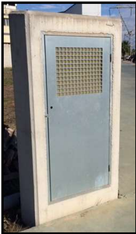
Figura 6. Detalle de hornacina para protecciones eléctricas e inversor.
