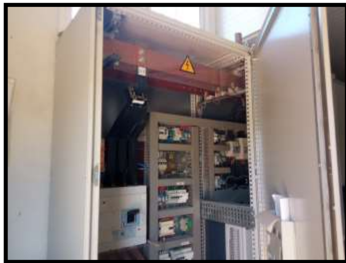
Figura 5. Detalle del cuadro principal existente
