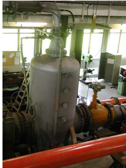
Figura 3.13. Depósito de agua con válvula de mariposa BV2 en la parte superior
