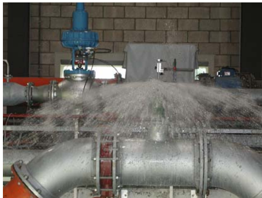
Figura 2.10. Fuga de agua por una ventosa. Ensayos de laboratorio
