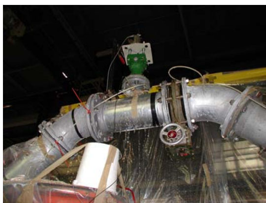
Figura 3.12. Válvula de mariposa BV1 junto a la ventosa
