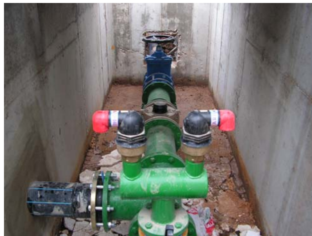
Figura 2.2. Ventosas en arqueta a la salida de un pozo
