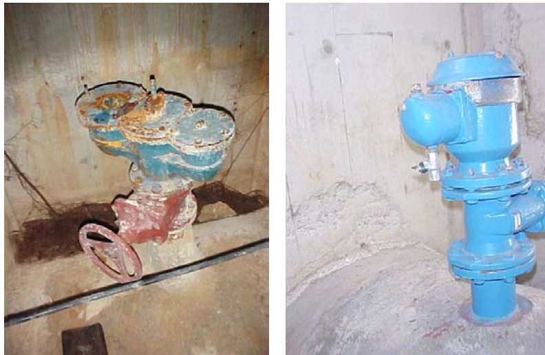
Figura 2.6. Ventosas trifuncionales instaladas en arquetas
