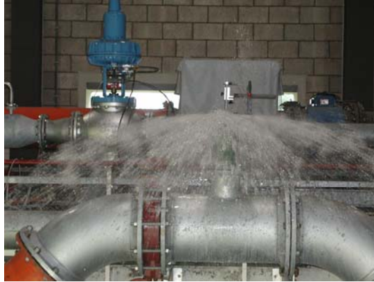
Figura 4.44. Fuga de agua a través de la ventosa
