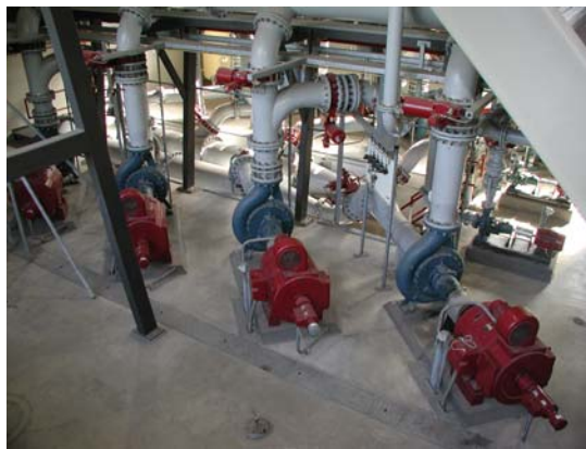
Figura 3.21. Sistema de bombeo
