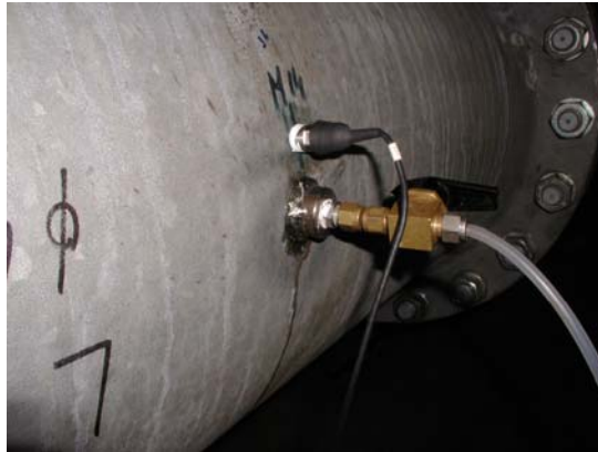
Figura 3.6. Transductor de presión instalado sobre la tubería
