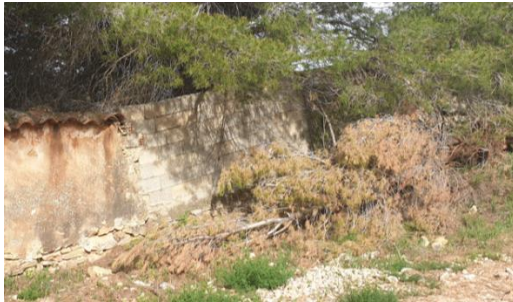
Ilustración 46_ Fábrica de bloque a demoler en muro norte. Fuente propia.
