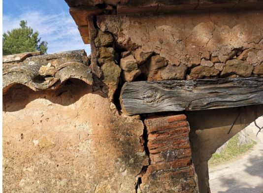
Ilustración 34_ Detalle Lesión 5.5_ Grietas. Fuente propia.
