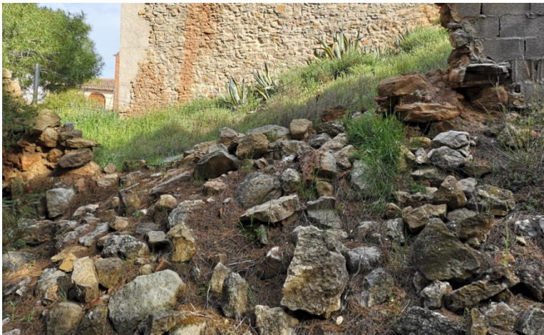
Ilustración 45_ Mampuestos de muro caído a recuperar. Fuente propia.
