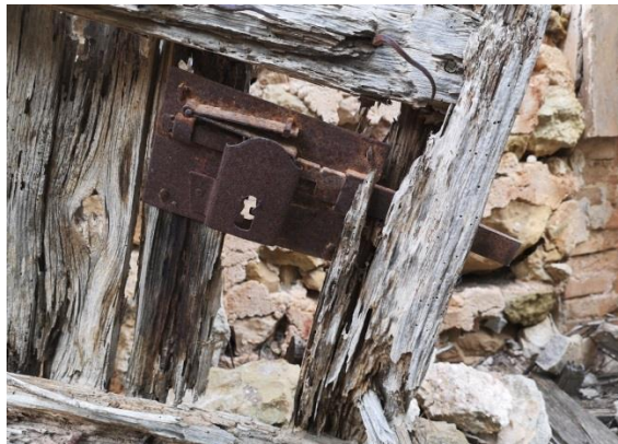
Ilustración 31_ Detalle Lesión 5.2_ Estado herrajes puerta de acceso. Fuente propia.
