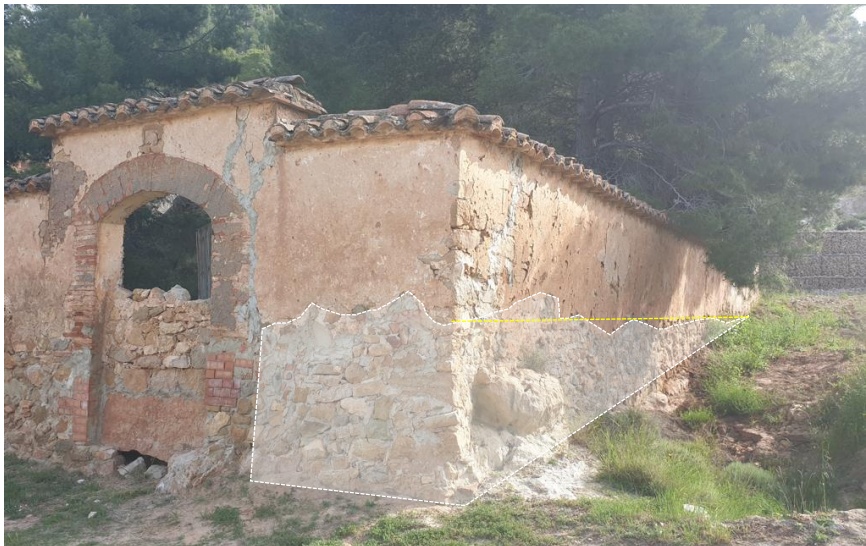
Ilustración 23_ Lesión 3.1_ Humedad capilar, salpicadura y escorrentía de torrentes de agua. Fuente propia.
