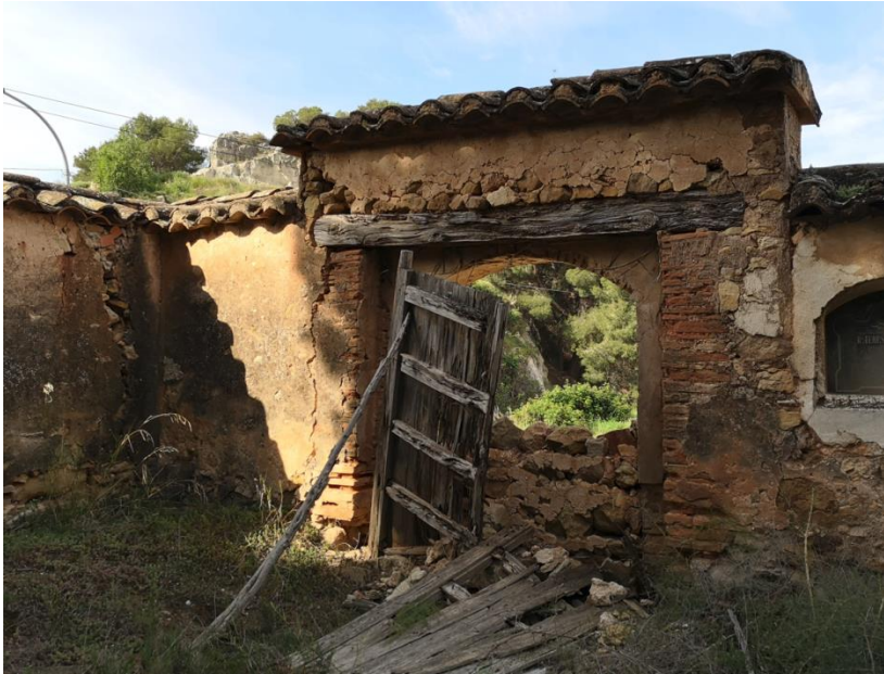
Ilustración 29_ Lesión 5_ Degradación generalizada de los elementos constructivos – Acceso. Fuente propia.
