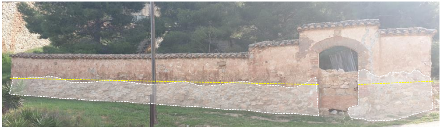
Ilustración 25_ Lesión 3.3_ Humedad capilar, salpicadura y escorrenría de torrentes de agua. Fuente propia.
