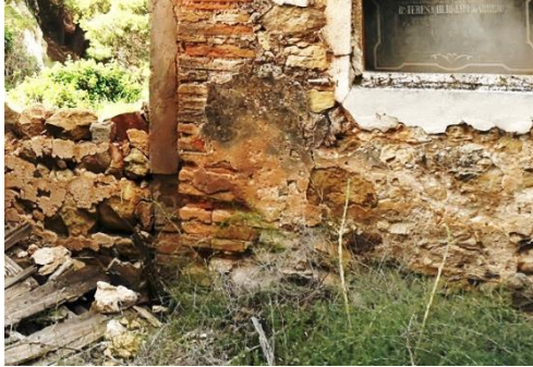
Ilustración 32_ Detalle Lesión 5.3_ Afección humedad ascensión capilar. Fuente propia.
