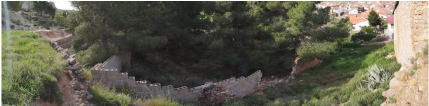
Ilustración 27_ Lesión 4_ Secciones de muros caídos. Fuente propia.
