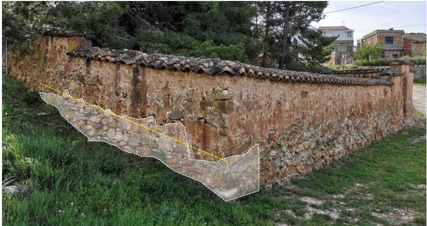
Ilustración 24_ Lesión 3.2_ Humedad capilar, salpicadura y escorrenría de torrentes de agua. Fuente propia.
