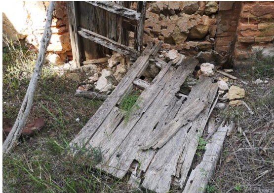
Ilustración 30_ Detalle Lesión 5.1_ Estado madera puerta de acceso. Fuente propia.
