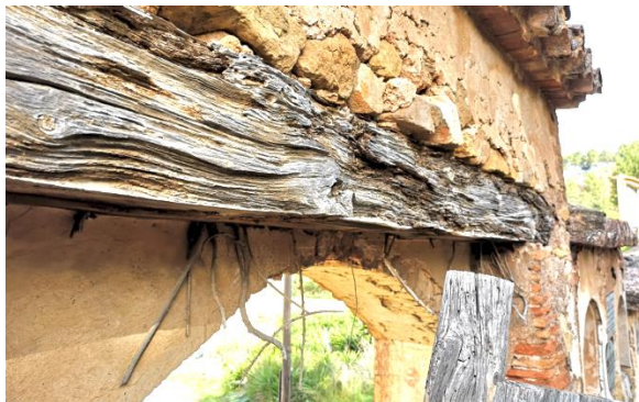
Ilustración 35_ Detalle aparición de raíces. Fuente propia.
