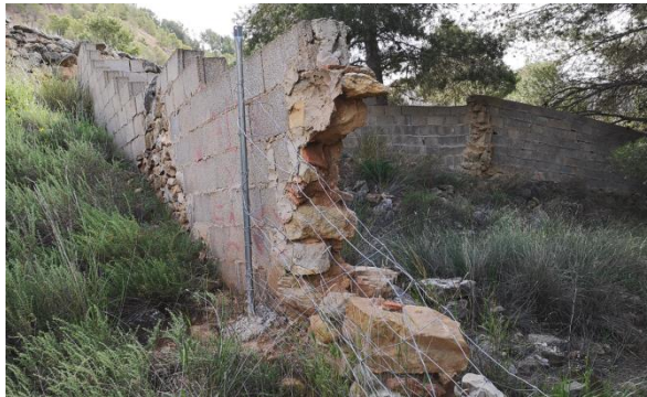
Ilustración 28_ Detalle Lesión 4_ Secciones de muros caídos. Fuente propia.
