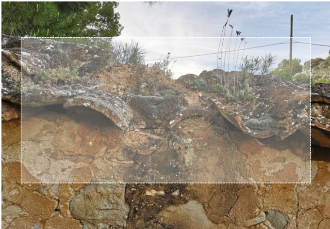
Ilustración 21_ Lesión 1_ Rotura de piezas de teja árabe y enraizado de materia vegetal. Fuente propia.
