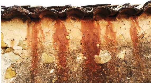
Ilustración 33_ Detalle Lesión 5.3_ Escorrentías en muro. Fuente propia.
