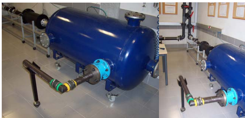
Figura 3.1 Fotografía del banco de flujo en proceso de un test tipo B
