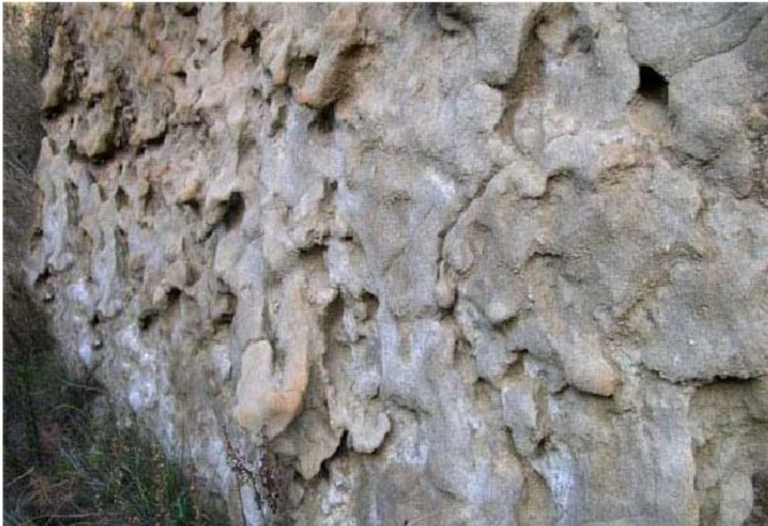
Figura13. Ataque por sulfatos. Fuente: Instituto de la construcción y gerencia ICG.
