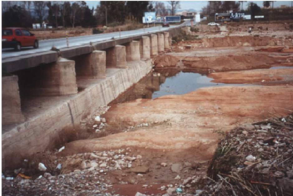
Figura 5.2. Fosas de socavación aguas abajo del puente de Canet tras el paso de la avenida de octubre de 2000
