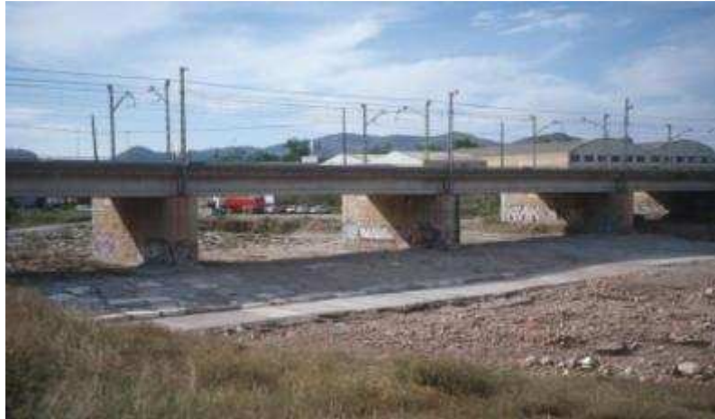
Figura 1.1. Puente de ferrocarril con solera protegida por un encachado de escollos que se extiende a lo largo de toda la sección transversal
