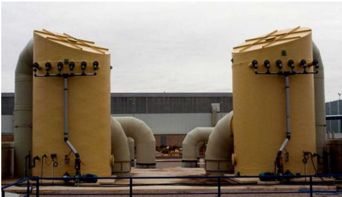
Figura 12.10.-Sistema de tratamiento de aire (biofiltros) Fuente: www.uteloshornillos.es
