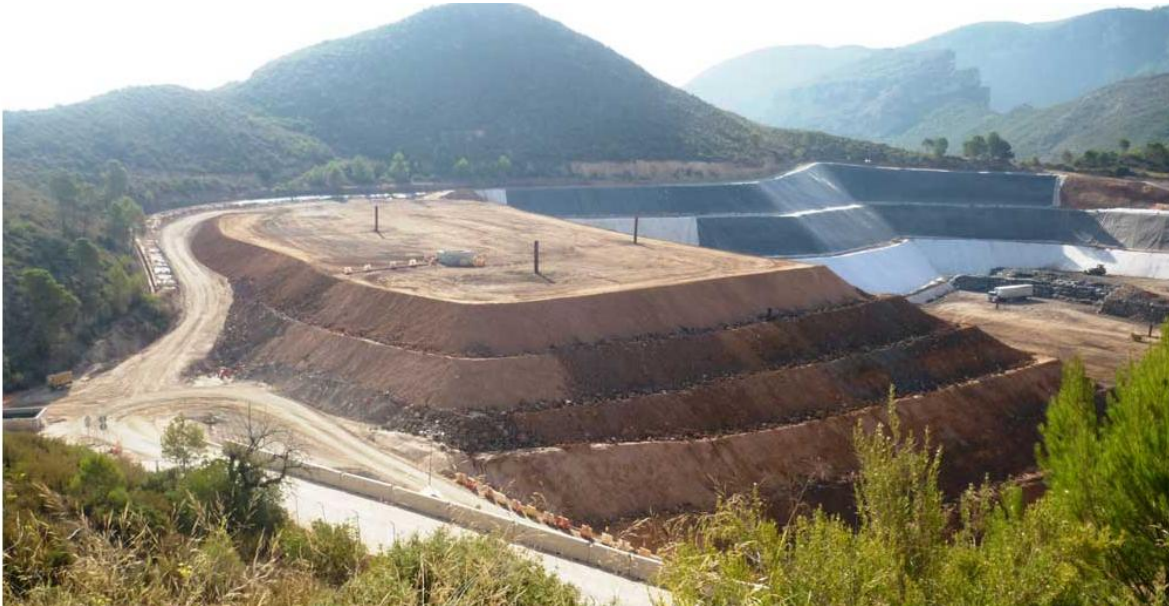
Figura 12.14.-Planta de eliminación de rechazos dos aguas Fuente: www.emtre.es
