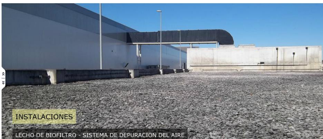
Figura 12.5.-Lecho de Biofiltro. Sistema de depuración del aire Fuente: www.uteloshornillos.es
