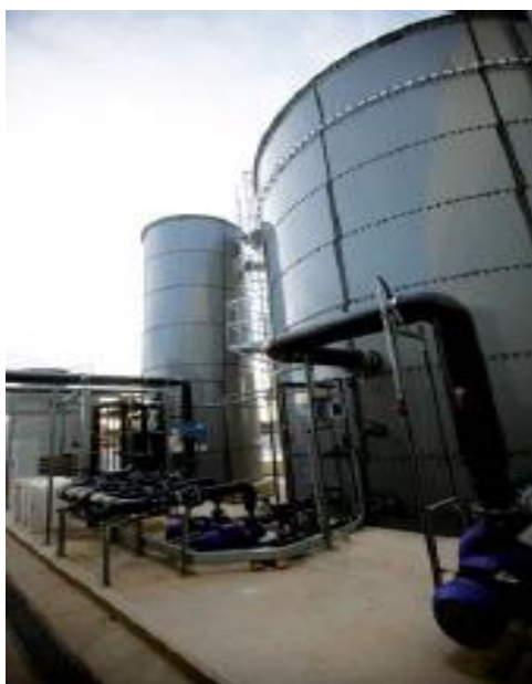
Figuras 12.20 y 12.21.-Tratamiento de lixiviados en depuradora
