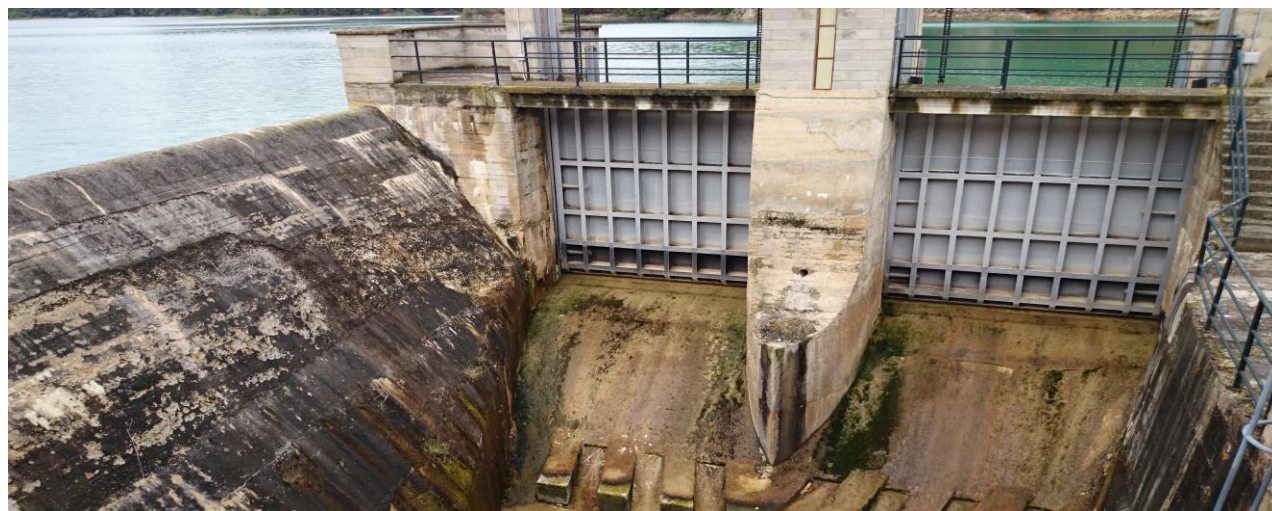
Fig.1 Situación actual del aliviadero
