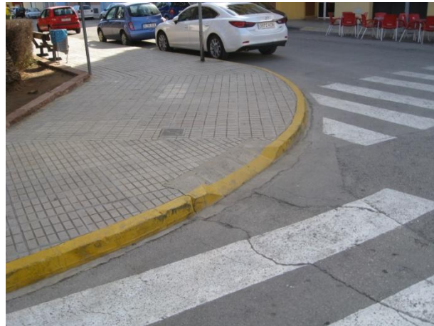
Imagen 7.48: Vado en acera próxima a la plaza reservada para PMR en estación RENFE.
