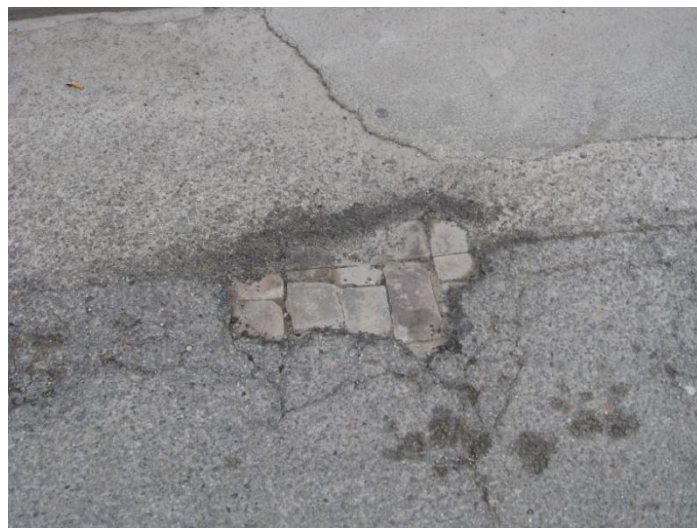
Imagen 7.18: Agujero en el asfalto en la calle Sueca.
