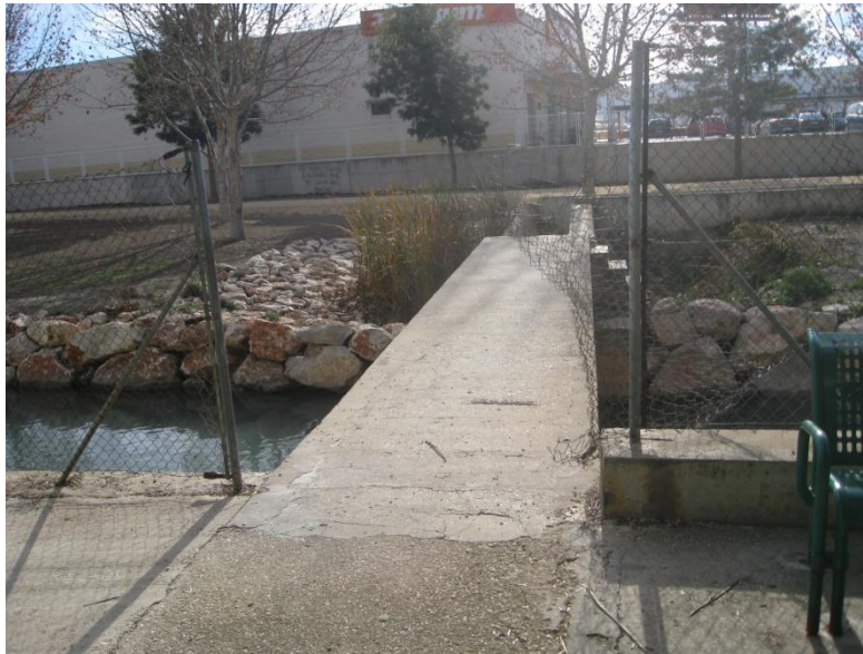
Imagen 7.32: Verja en mal estado.
