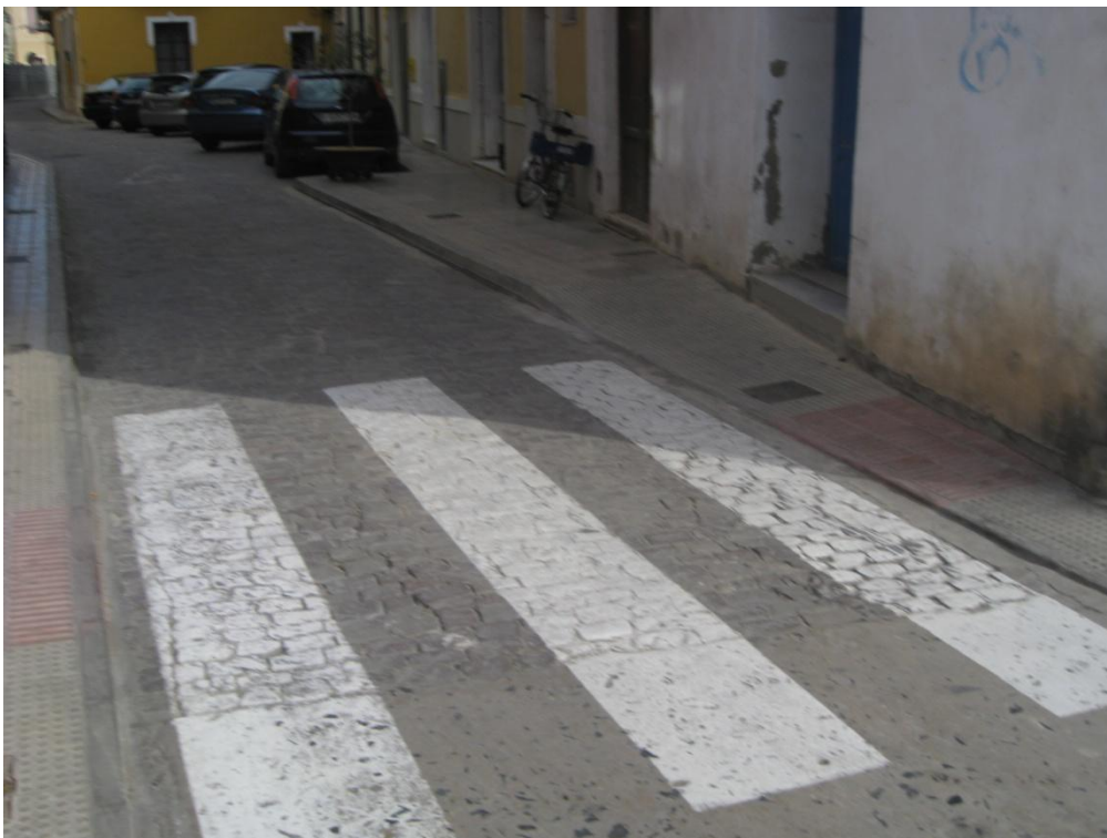
Imagen 7.16: adoquinado en calle Mingarro
