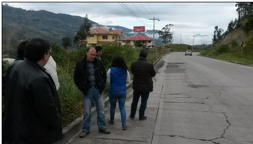
Ilustración 17 Grietas en calzada debido a asentamientos
