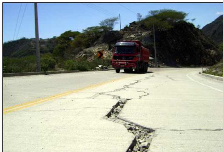
Ilustración 9 Gritas en la calzada debido a deslizamiento
