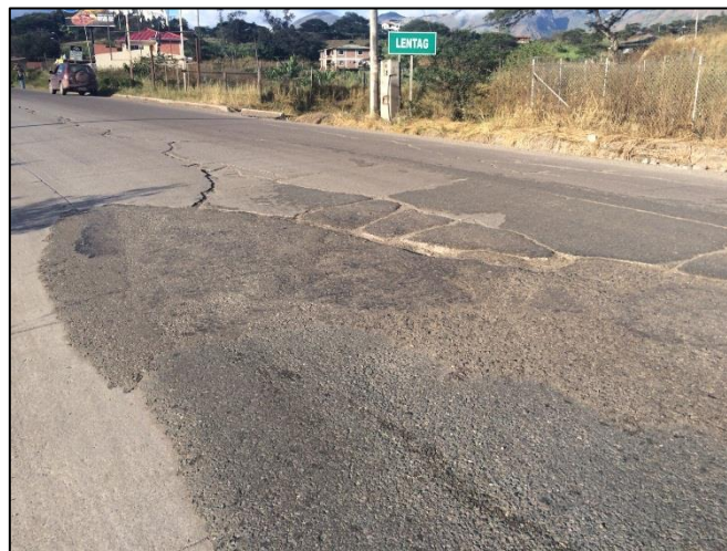
Ilustración 19 Desgaste del pavimento
