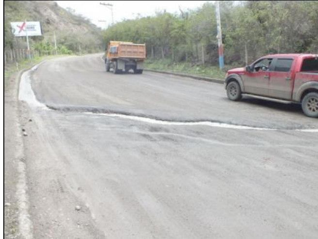
Ilustración 20 Hundimientos en la calzada
