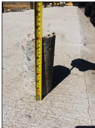
Ilustración 15 Muestra de hormigón de la calzada
