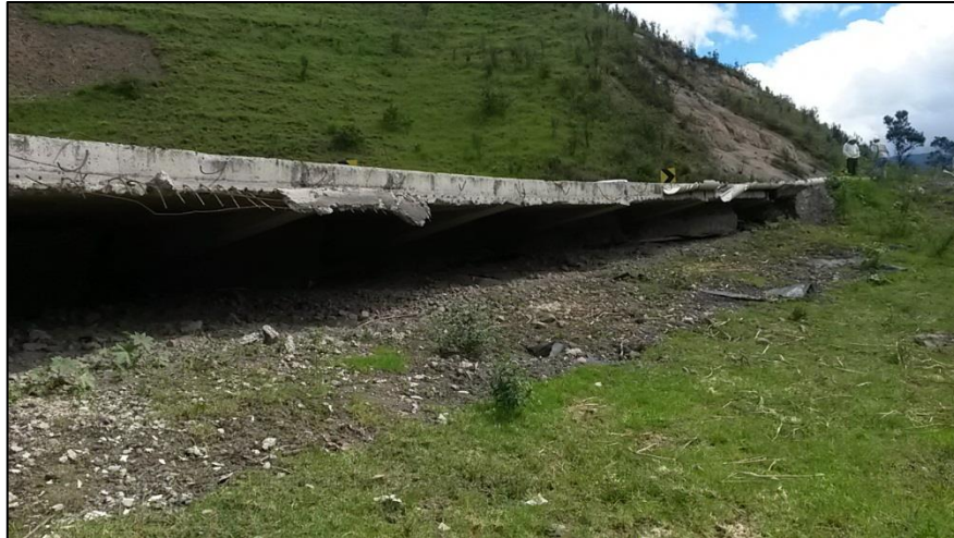
Ilustración 8 Terraplén afectado PK 45+000
