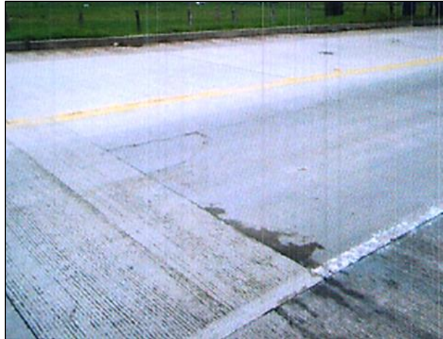
Ilustración 18 Presencia de agua en juntas de losas
