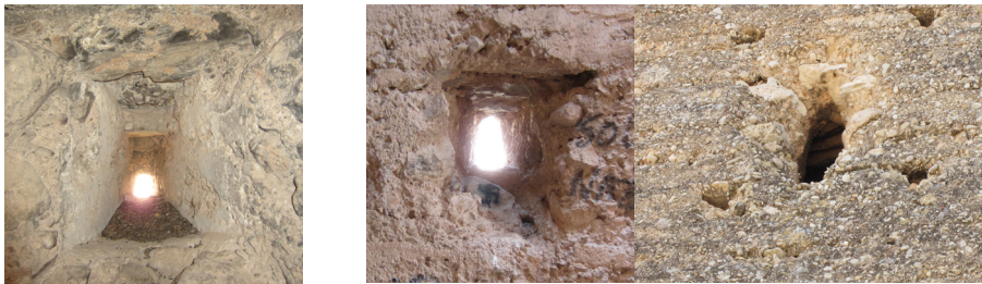
Fig. 7.41 - 7.43. Saetera intradós Norte, nivel 1. Saetera interior- exterior alzado Norte, nivel 2.
