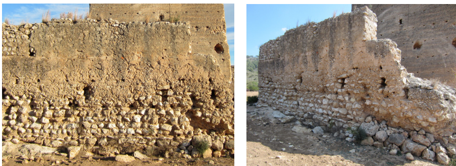
Fig. 9.9 - 9.10. Vistas de la erosión y desprendimiento del albacar.
