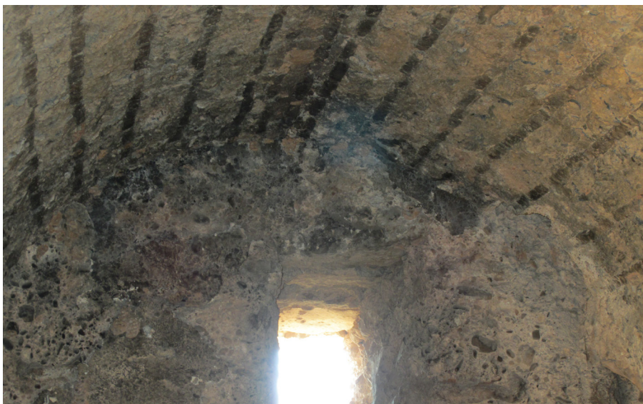
Fig. 9.40. Humedades en la bóveda del nivel 1.
