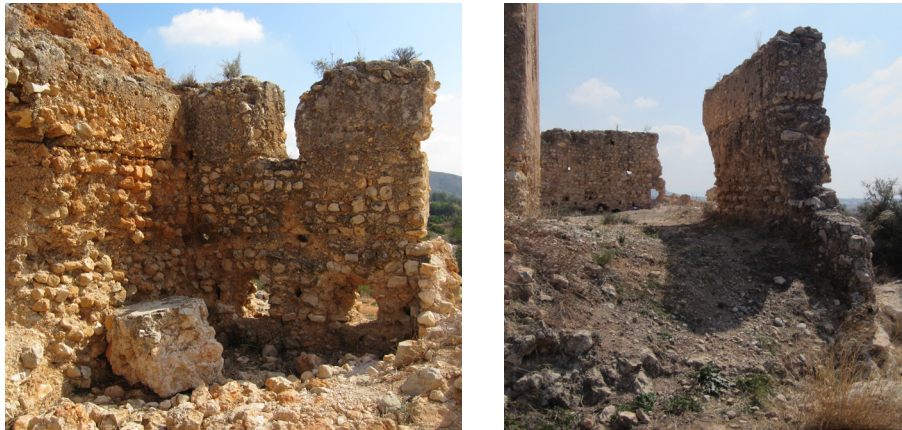
Fig. 9.1 - 9.2. Vistas de los alzados Norte y Sur del albacar en su cara interior
