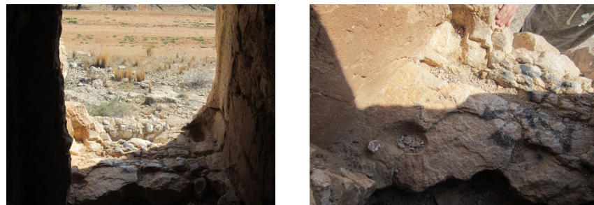
Fig. 7.35 - 7.36. Detalle del desgaste de la sillería del acceso.
