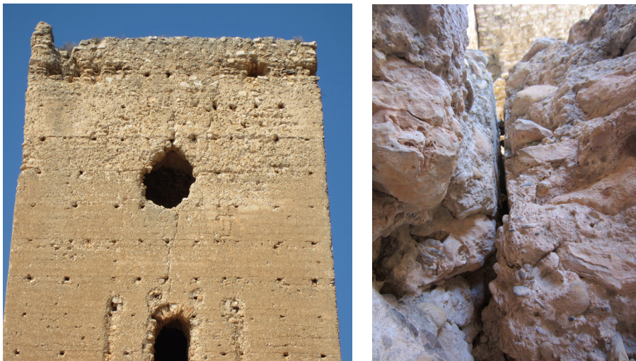
Fig. 9.14 - 9.15. Grietas en el alzado Este y en la unión del forjado con el muro del nivel 3.
