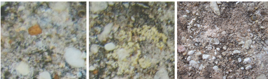
Fig. 9.21 - 9.23. Diferentes líquenes en la fachada Norte
