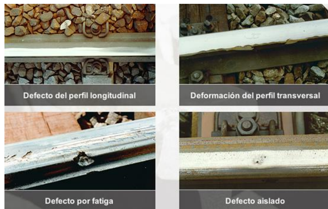
Figura 15. Ejemplo de defectos producidos por el desgaste de la circulación de los trenes.
