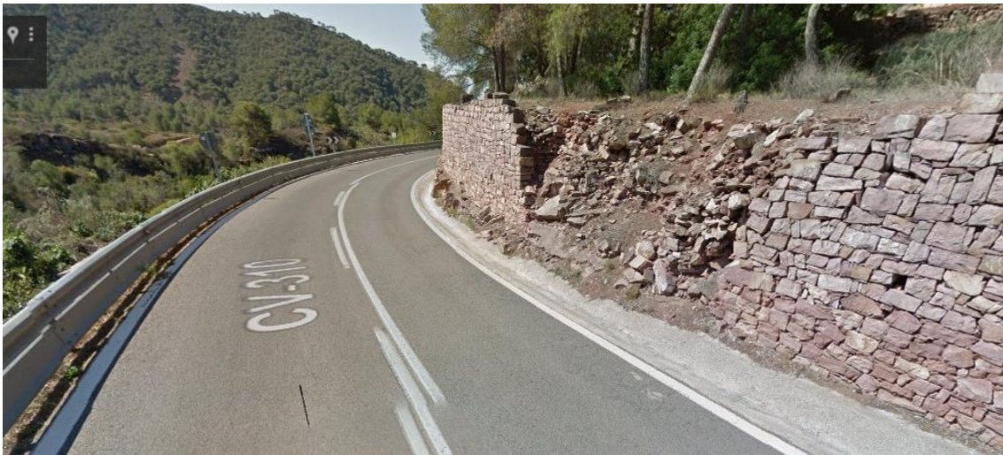
Imagen 39: ejemplo de primer muro de contención de tierras parcialmente derruido 2 (Contenidos audiovisuales/capturas de Google/ El Tochar-Serra/P.K. 21+000 (446).jpg)
