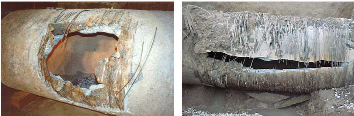
FIGURA 26. DOS TIPOS DE ROTURAS DE UNA TUBERÍA DE HORMIGÓN ARMADO.
