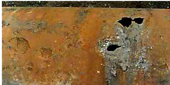
FIGURA 22. EJEMPLO DE CORROSIÓN EN TUBERÍA DE FUNDICIÓN DÚCTIL.
