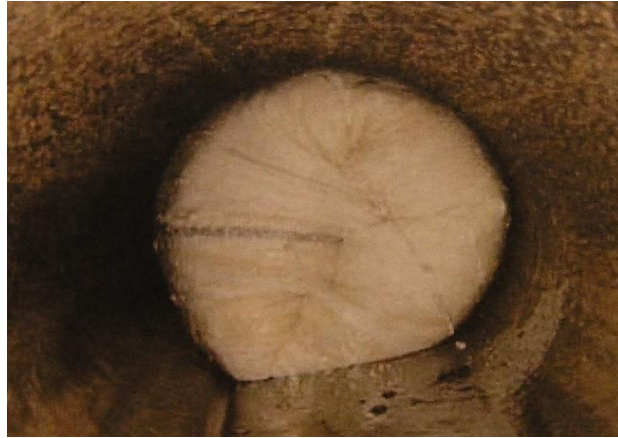
FIGURA A.27. PROCESO DE REVERSIÓN DE LA MANGA SOBRE LA ANTIGUA CONDUCCIÓN.
