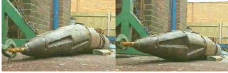
FIGURA A.32. MOVIMIENTO DEL CABEZAL DE TIRO QUE PRODUCE LA ROTURA DE LA CONDUCCIÓN.
