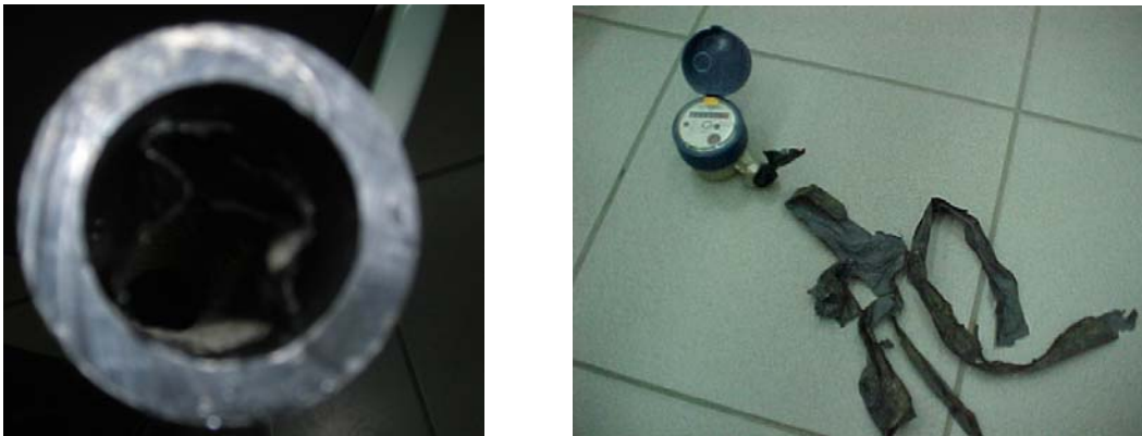
FIGURA 31. DECAPADO INTERNO DE LAS TUBERÍAS DE LDPE Y PROBLEMAS DE OBSTRUCCIÓN DE UN CONTADOR DOMICILIARIO (CORTESÍA DE AGUAS DE VALENCIA).
