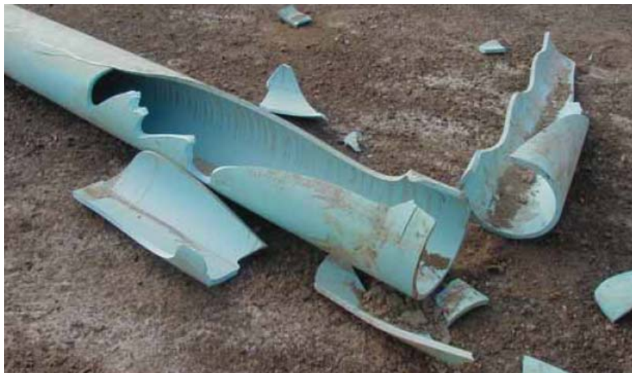
FIGURA 28. ROTURA LONGITUDINAL DE UNA TUBERÍA DE 300 MM DE PVC.
