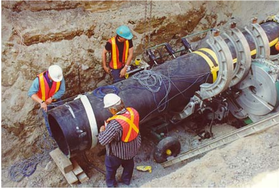
FIGURA A.20. UNIÓN POR SOLDADURA DE UNA TUBERÍA EN UNA CATÁ DE ENTRADA.
