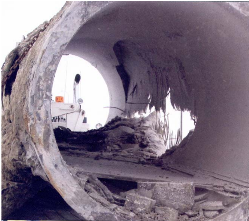
FIGURA 27. ROTURA DE TUBERÍAS DE GRAN DIÁMETRO HORMIGÓN ARMADO Y PRETENSADO (RAJANI, 2009A).
