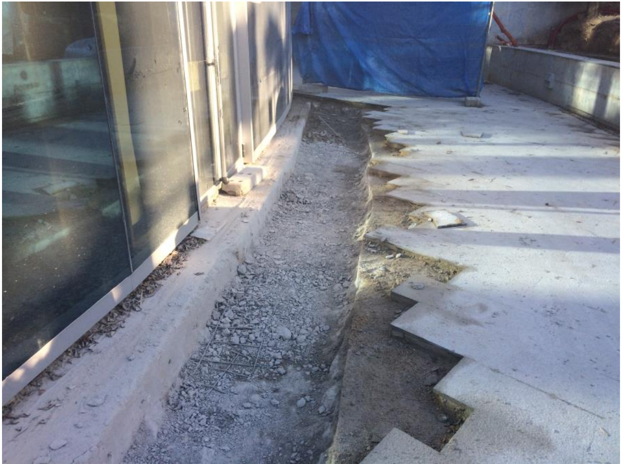
Picado de la losa en la zona de acceso al auditorio Mar Rojo.
