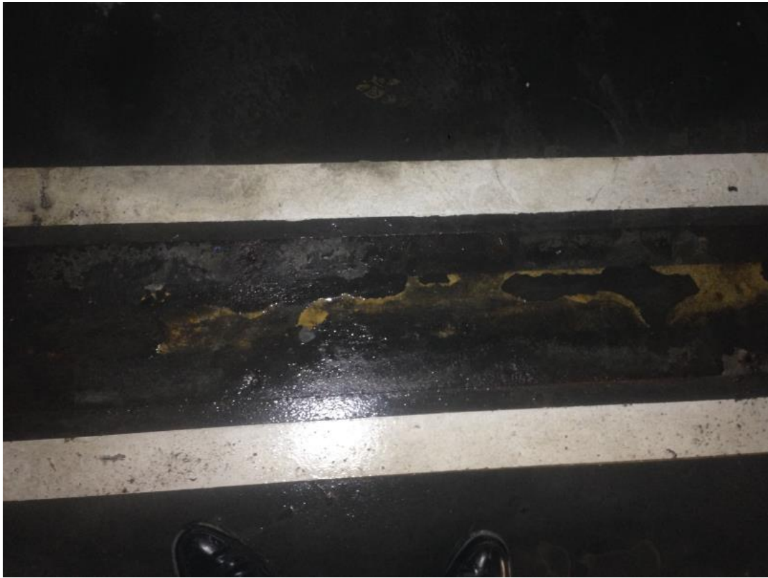
Junta de dilatación dañada por la acción del agua.
