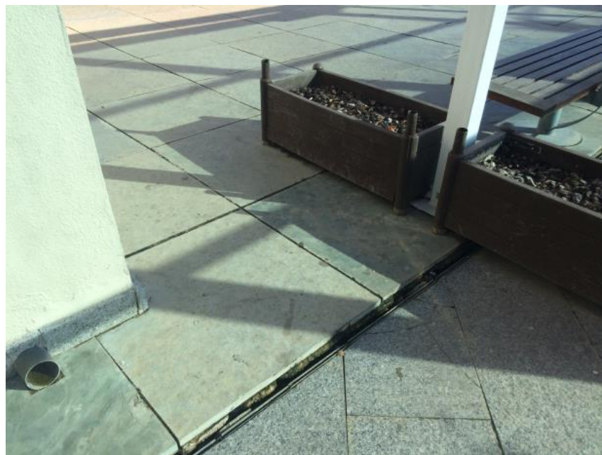
Figura 21. Asiento diferencial en la Plaza de Acceso entre dos losas apoyadas en diferentes superficies (una en muro de sótano y forjado y otra en terreno natural). 2017. Fuente: Fotografía tomada en obra. Martín Arcos, J. J.
