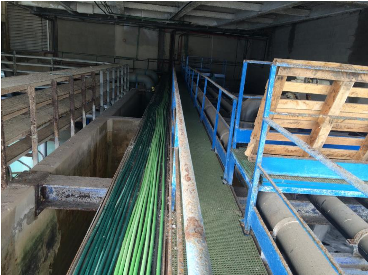
Barandillas metálicas debilitadas por el ambiente húmedo en el que se encuentran.
