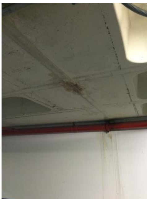
Figura 15. Filtración de agua en el forjado superior del parking. 2017. Fuente: Fotografía tomada en obra. Martín Arcos, J. J.
