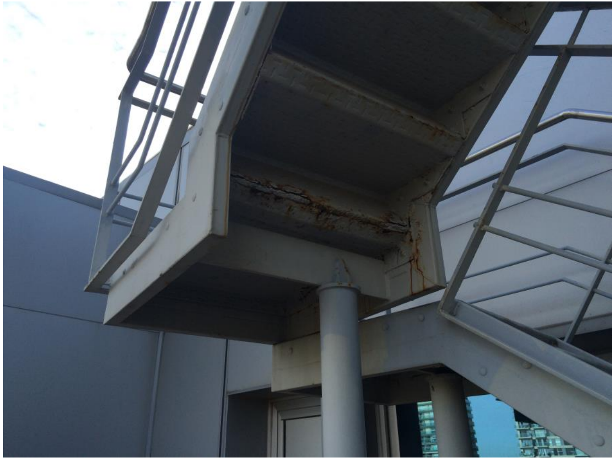
Escalera oxidada objeto de la reparación.
