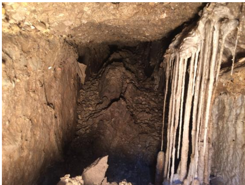
Figura 26. Zanja de 0,80 m encontrada en el asiento diferencial de la Plaza de Acceso debido al lavado del terreno por la acción del agua. 2017. Fuente: Fotografía tomada en obra. Martín Arcos, J. J.
