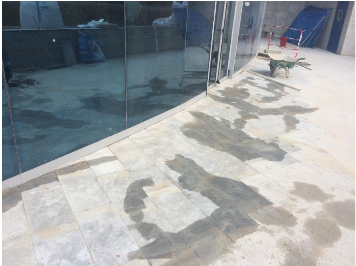
Comprobación de las roturas producidas en el pavimento tras su colocación con la prueba de agua en la zona de acceso al auditorio Mar Rojo.
