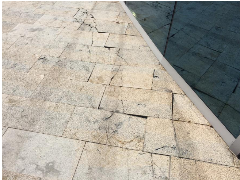
Figura 22. Pavimento roto ocasionado por el asiento diferencial localizado en el exterior del auditorio Mar Rojo. 2017. Fuente: Fotografía tomada en obra. Martín Arcos, J. J.
