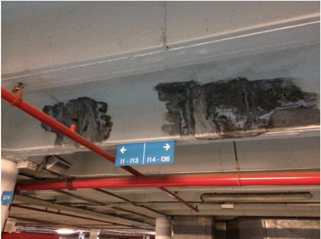
Estructura debilitada por las filtraciones.
