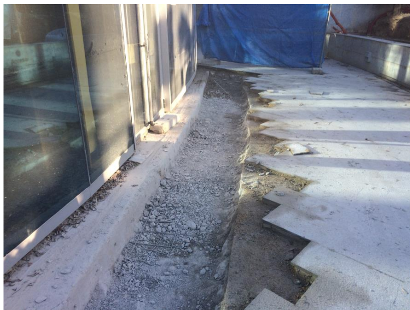
Figura 28. Zanja antes de colocar acero y hormigonar en el exterior del auditorio Mar Rojo. 2017. Fuente: Fotografía tomada en obra. Martín Arcos, J. J.
