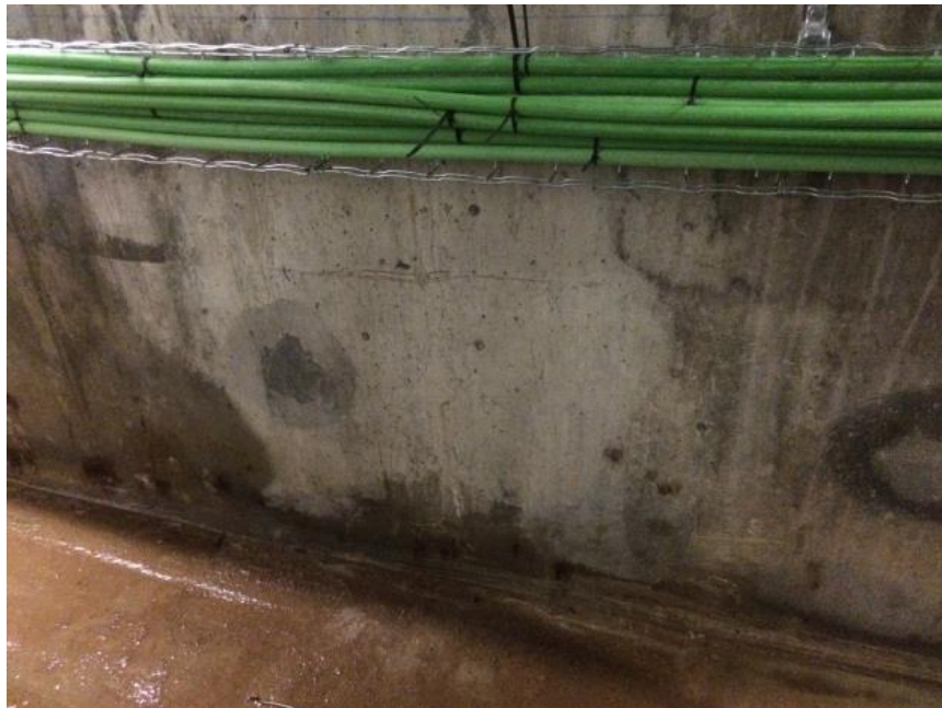
Figura 4. Estado de la patología de manchas de humedad en estructuras de hormigón. 2017. Fuente: Fotografía tomada en obra. Martín Arcos, J. J.
