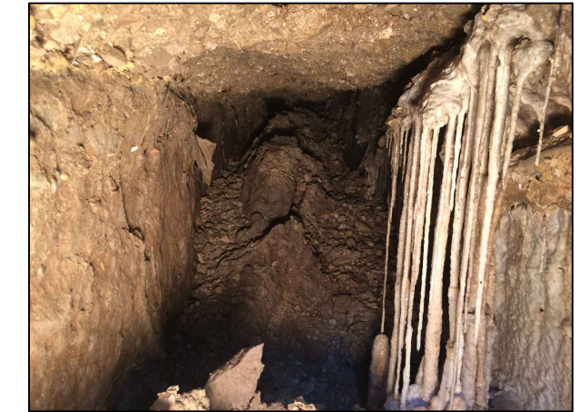
Zanja bajo solera encontrada tras realizar la cata
