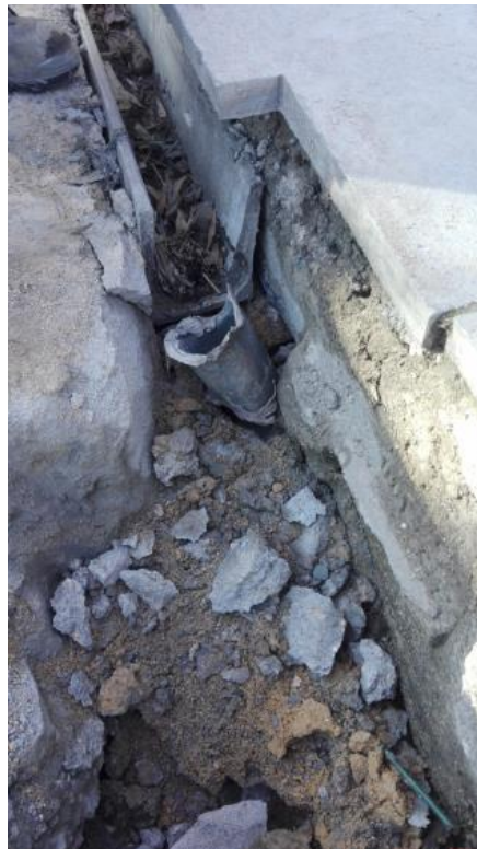
Figura 27. Instalaciones dañadas debido al asiento diferencial ocasionado entre las estructuras de cimentación de la Plaza de Acceso. 2017. Fuente: Fotografía tomada en obra. Martín Arcos, J. J.
