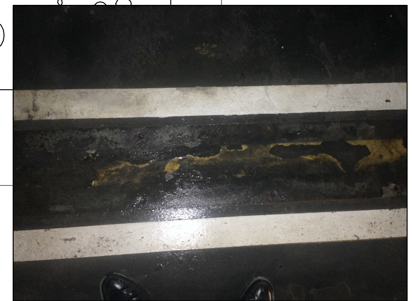
Fotografía tomada en obra del estado actual de las juntas.
