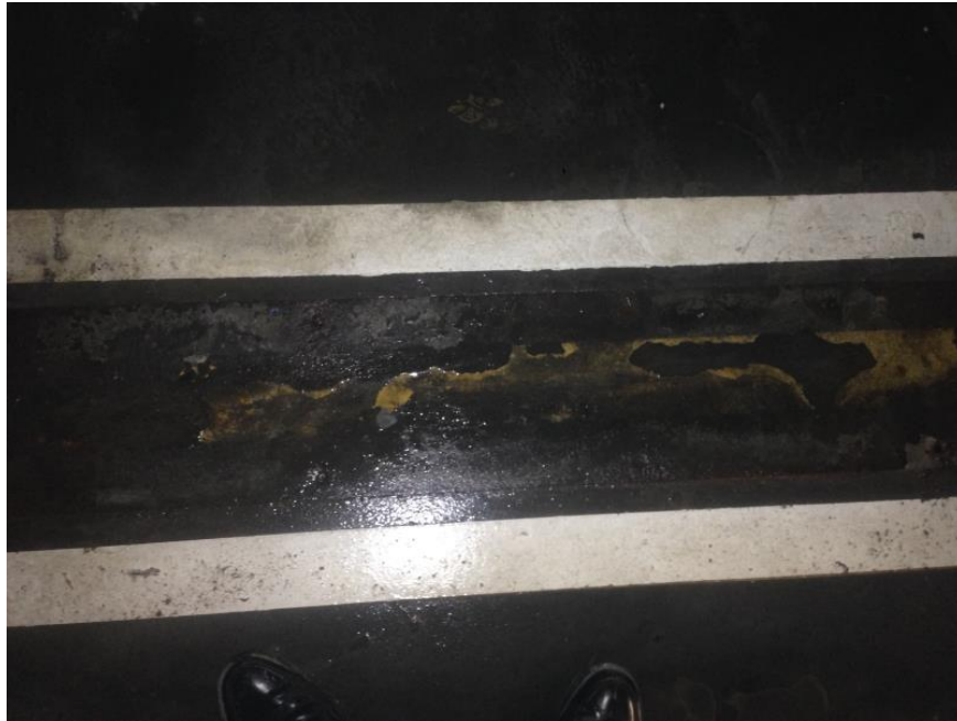
Figura 16. Filtración de agua en una junta de dilatación dañada. 2017. Fuente: Fotografía tomada en obra. Martín Arcos, J. J.
