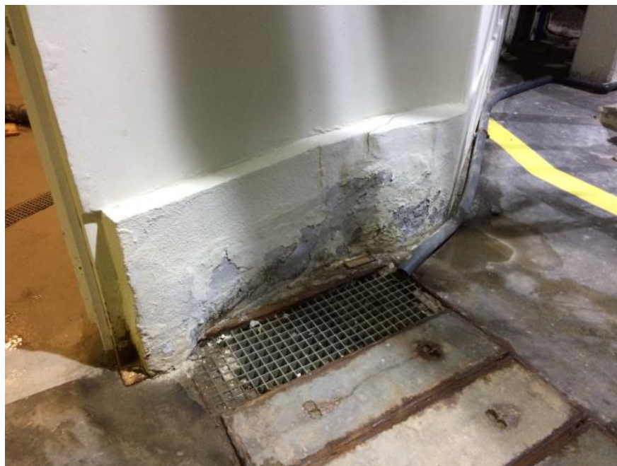
Figura 19. Desconchado en el revestimiento y manchas de humedad detectados en paramento vertical en la “Galería Técnica”. 2017. Fuente: Fotografía tomada en obra. Martín Arcos, J. J.
