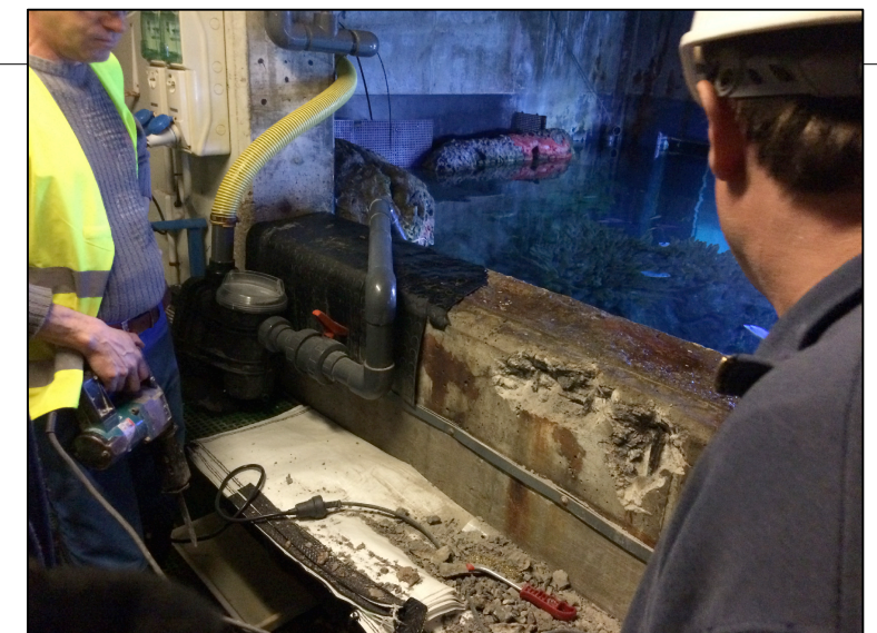
Fotografía tomada durante el picado del hormigón afectado hasta llegar al armado interior.
