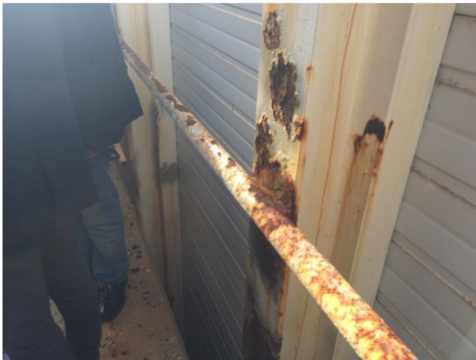
Figura 11. Estructura metálica dañada por corrosión. 2017. Fuente: Fotografía tomada en obra. Martín Arcos, J. J.
