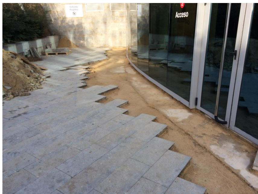
Figura 24. Línea que diferencia entre las cimentaciones y muestra el asiento diferencial en el exterior del auditorio Mar Rojo. 2017. Fuente: Fotografía tomada en obra. Martín Arcos, J. J.
