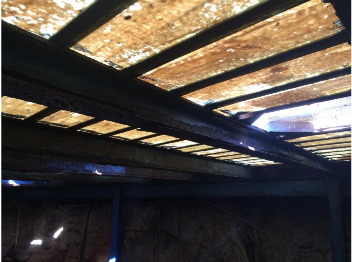
Estructura metálica debilitada por el ambiente húmedo en el que se encuentra.
