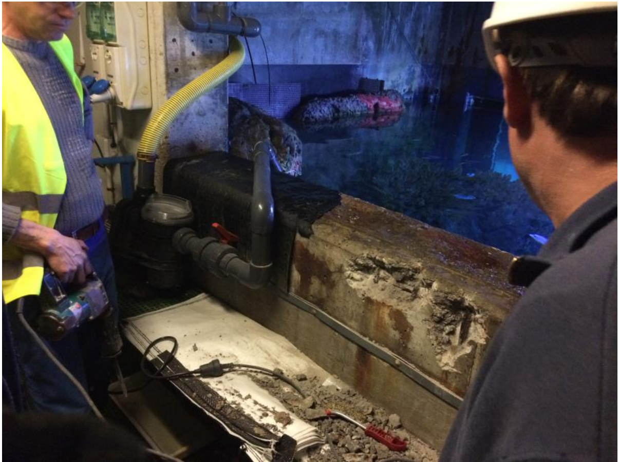
Armadura vista del paramento objeto de la reparación
