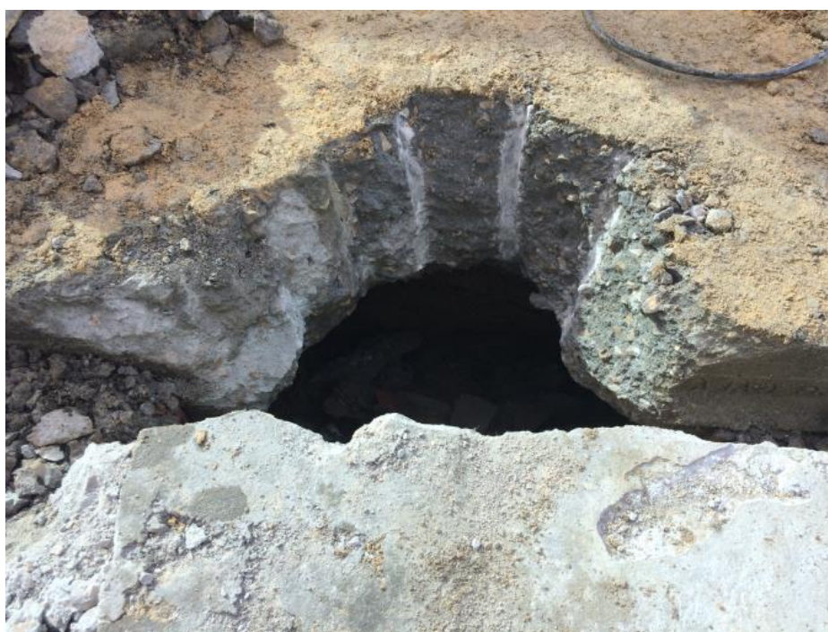
Figura 25. Zanja de 0,80 m encontrada en el asiento diferencial de la Plaza de Acceso debido al lavado del terreno por la acción del agua. 2017. Fuente: Fotografía tomada en obra. Martín Arcos, J. J.
