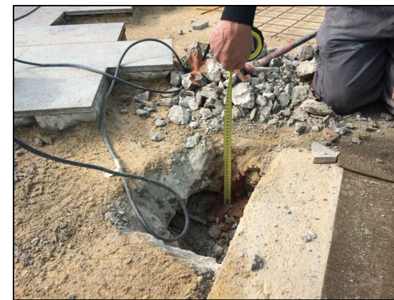
Foto de la losa con el mallazo en la parte inferior colocado (cata 1).
