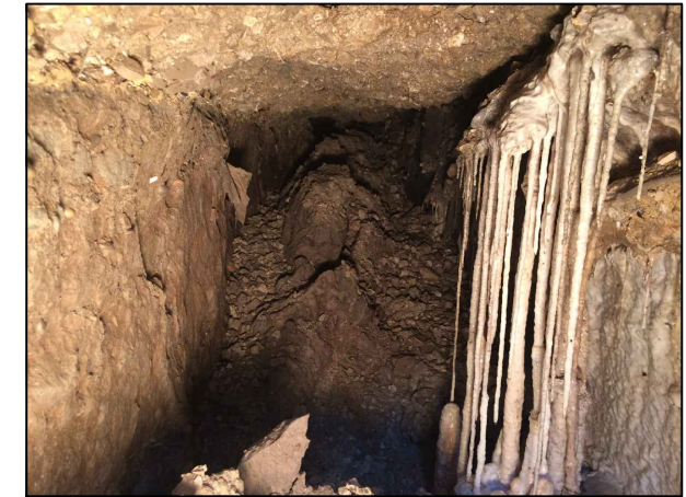
Zanja bajo solera encontrada tras realizar la cata
