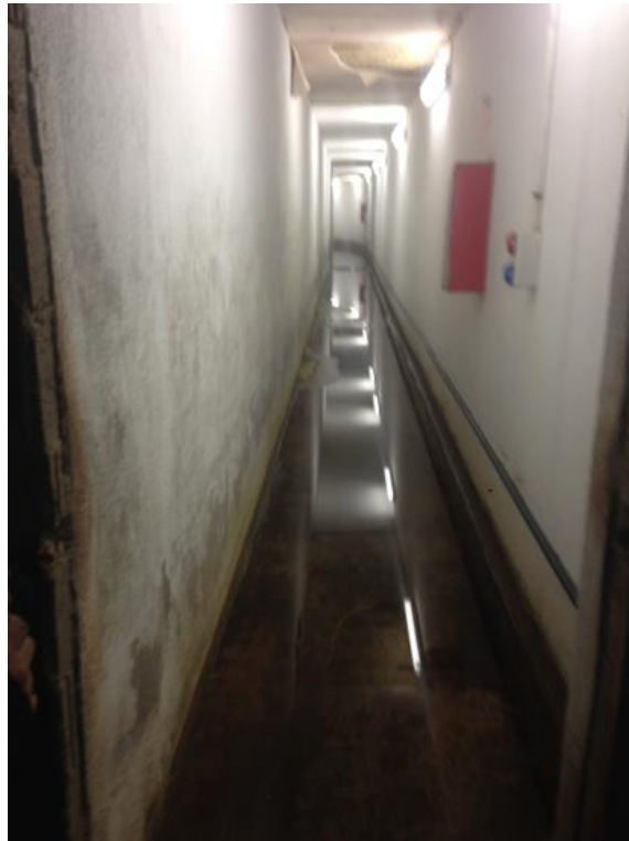
Figura 20. Pasillo inundado debido a la filtración de agua a través de juntas de dilatación como de muro en contacto con el terreno. 2017. Fuente: Fotografía tomada en obra. Martín Arcos, J. J.
