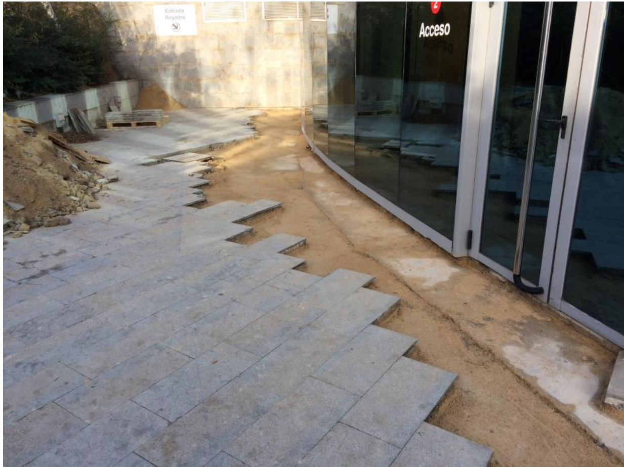
Levantado del pavimento en la zona de acceso al auditorio Mar Rojo.
