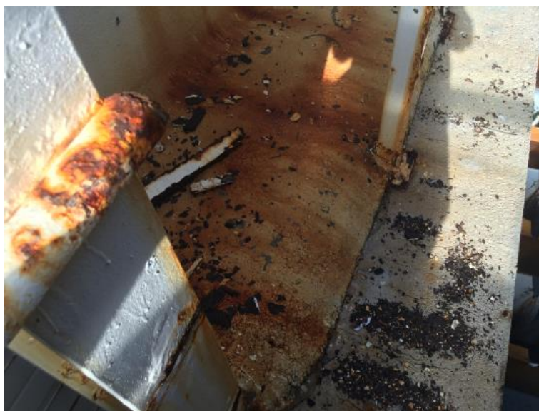
Figura 14. Pérdida total de la sección de una barandilla metálica. 2017. Fuente: Fotografía tomada en obra. Martín Arcos, J. J.
