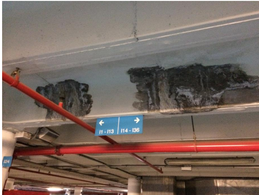
Figura 17. Manchas de humedad detectados en el forjado superior del pàrking. 2017. Fuente: Fotografía tomada en obra. Martín Arcos, J. J.
