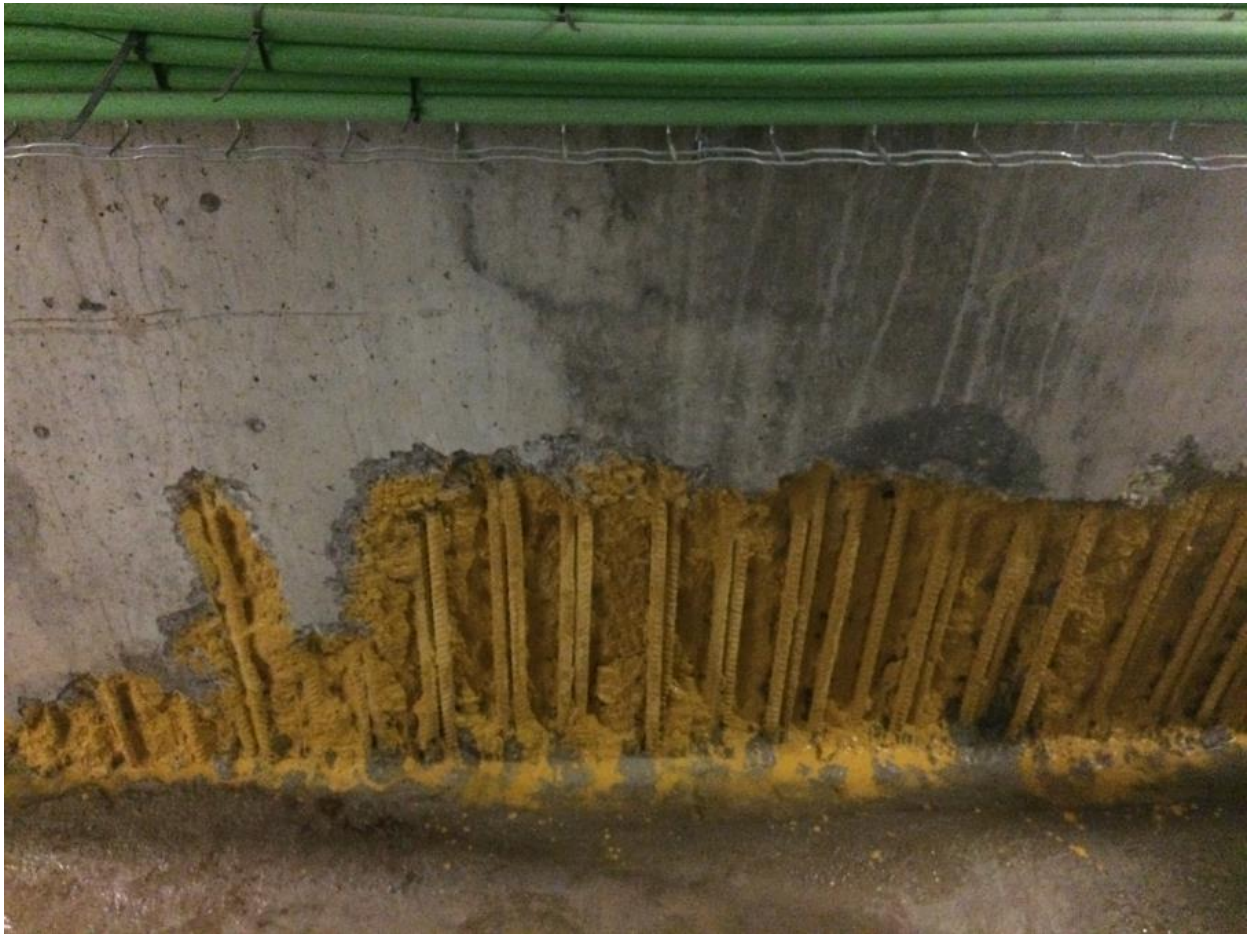
Tratamiento de pasivado a las armaduras que componen los muros de hormigón
