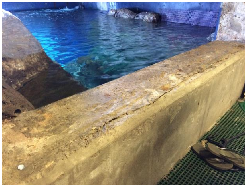
Figura 6. Coronación de muro en borde de tanque dañado por los efectos de la carbonatación. 2017. Fuente: Fotografía tomada en obra. Martín Arcos, J. J.
