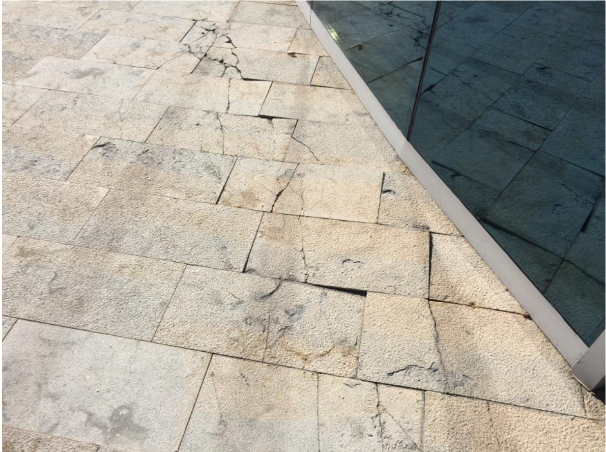
Pavimento dañado en el asiento diferencial del acceso al auditorio Mar Rojo.
