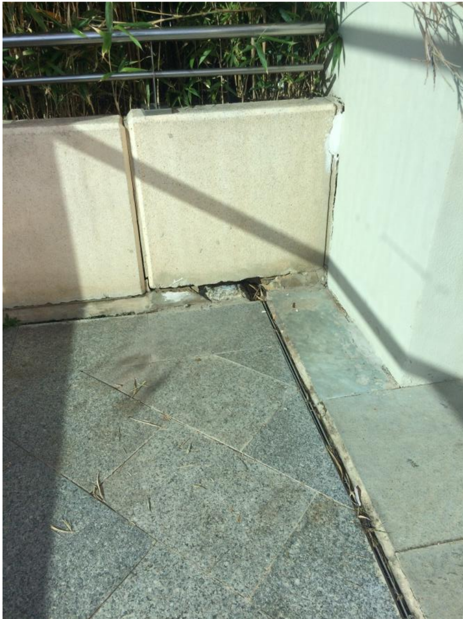
Uno de los muretes de contención de tierras de las jardineras de la Plaza de Acceso que muestra claramente la falta de apoyo debido al asiento diferencial originado.
