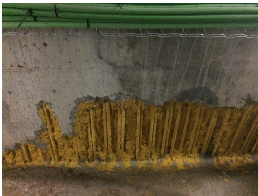
Figura 9. Aplicación de capa de pasivado de armadura de acero del muro y a su vez puente de unión acero-mortero y mortero-mortero. 2017. Fuente: Fotografía tomada en obra. Martín Arcos, J. J.
