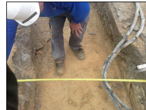
Canaleta deteriorada en el encuentro entre cimentación
