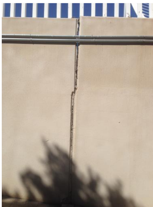
Figura 23. Grieta ocasionada debido al asiento diferencial que ha sufrido la rampa de acceso a la "Galería Técnica", coincidiendo con la junta de dilatación. 2017. Fuente: Fotografía tomada en obra. Martín Arcos, J. J.
