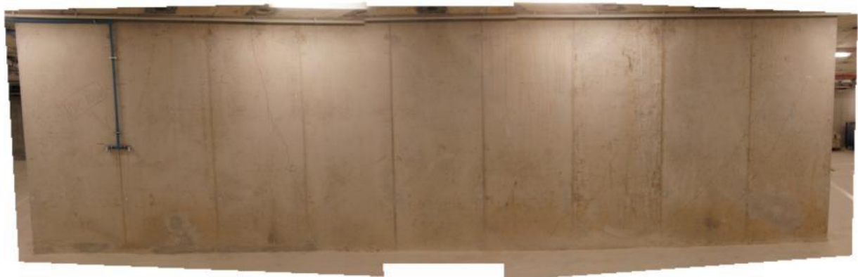
Figura 23. Aparente estabilización de fisuración en zona central del muro interior. (AICEQUIP, (2013)).
