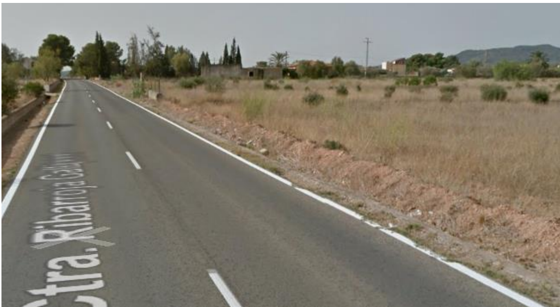
Imagen 6. Cuneta sobredimensionada en la margen derecha. PK 2+200.
