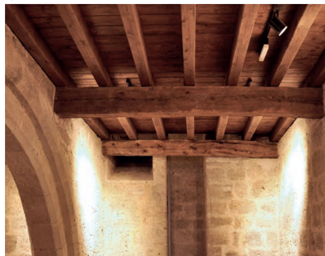
11, 12 y 13. Forjado de planta primera antes, en fase y después de la intervención.
