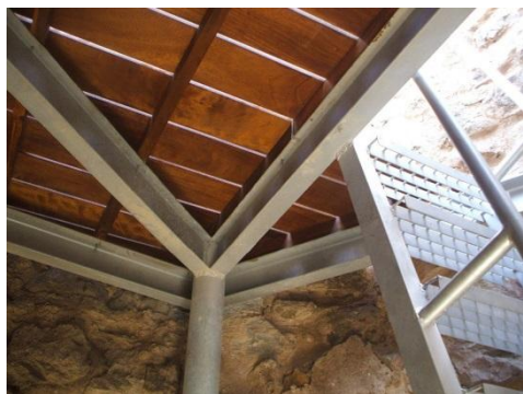
Fig. 7.- Detalle del interior de la Torre con la solución de la cubierta. (P.E. Collado)
