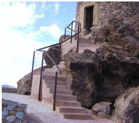
Fig. 5.- Detalle de la nueva escalera de hormigón coloreado y barandilla metálica para acceso a la Torre. (P.E. Collado)
