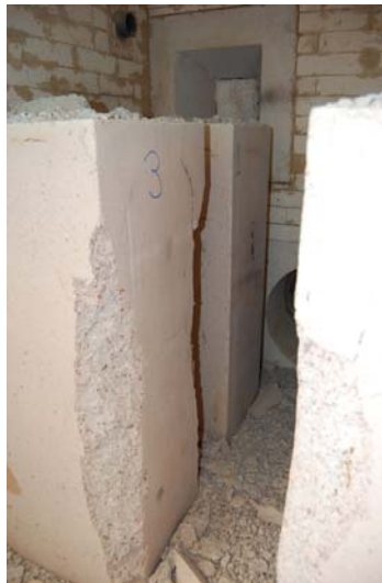
Figura 142. “Spalling” en los pilares
