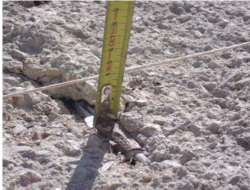
Figura 141. “Spalling” de la losa
