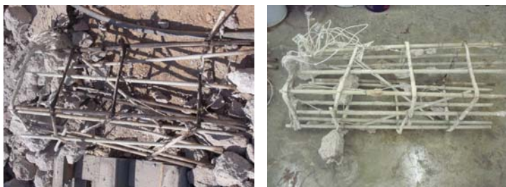
Figura 150. Armaduras recuperadas tras la carga de fuego de los pilares 1 y 4
