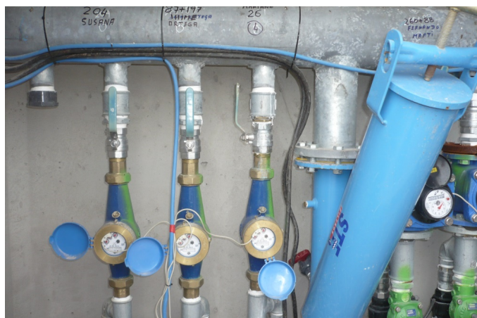
Figura 3. Hidrante multiusuario con contadores en posición vertical y flujo descendente.
