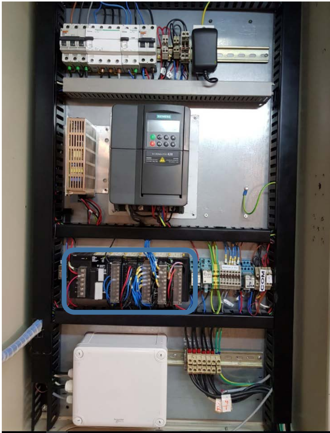
Ilustración 27: Instalación del PLC en el armario de control
