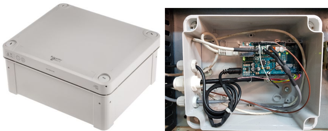
Ilustración 31. Caja utilizada para las conexiones del módulo de notificación
