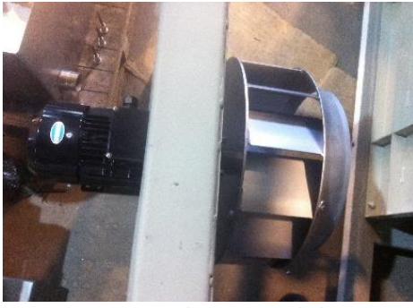
Fig. 23 Panel motor ventilador
