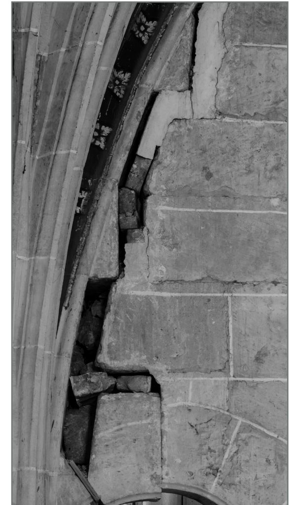
Imagen 19. Fisuración del encuentro entre arco formero de la nave lateral y muro del paramento exterior. Fenómeno desplazamiento dovela por movimiento horizontal.
