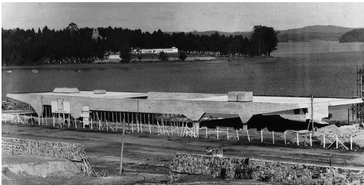
Imagen 23: Garaje de Barcos del Club de Yates de Santa Paula en construcción. Fuente: Vilanova Artigas. Instituto Lina Bo e P.M. Bardi. Ed: São Paulo
