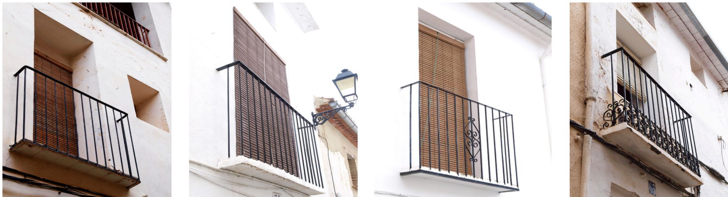
FIGURA 47. Balcons en voladís de forja
