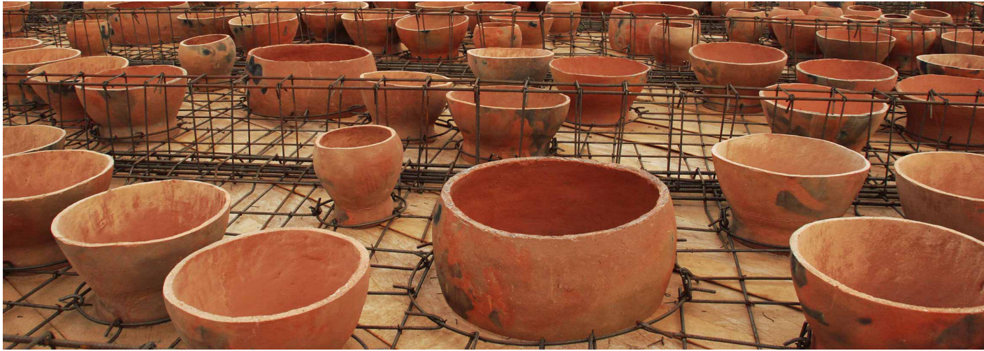
IMAGEN 117. Construcción de la cubierta de la biblioteca del campus de educación primaria de Gando
