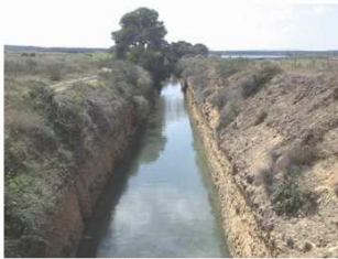
RPC_5_Canal de La Mata: Canal de aproximadamente 8 m de anchura y 1.750 m de longitud que permite introducir agua del mar Mediterráneo en la Laguna de La Mata.
