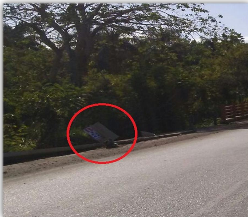
Figura 13. Señal vertical en mal estado en la carretera El Seibo - Hato Mayor.
