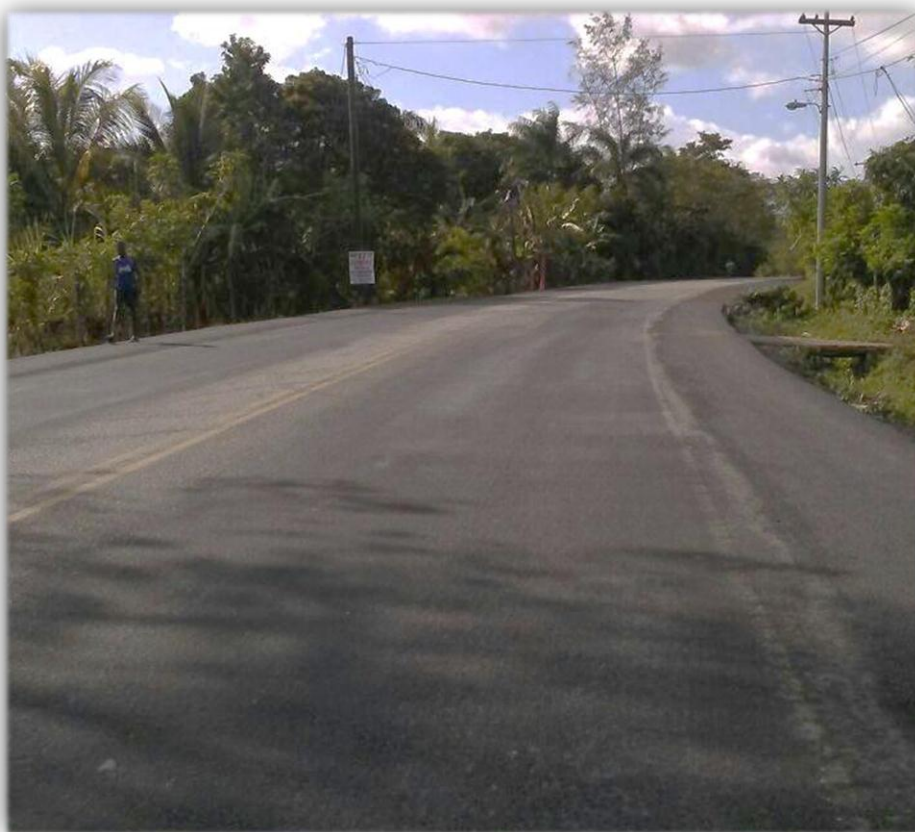
Figura 11. Ausencia de señalización vertical en la carretera El Seibo – Hato Mayor.
