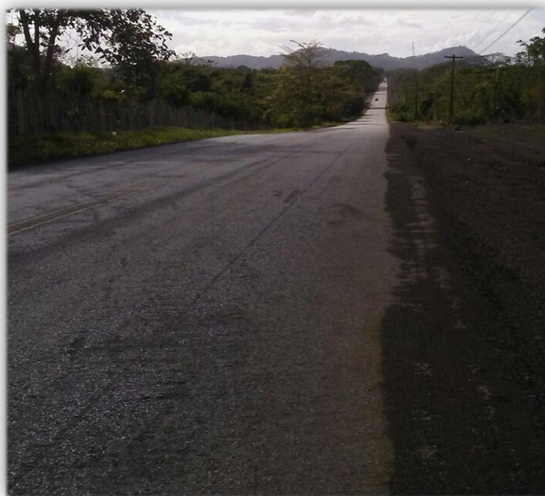
Figura 20. Acumulación de lodo en el arcén de la carretera El Seibo – Hato Mayor.
