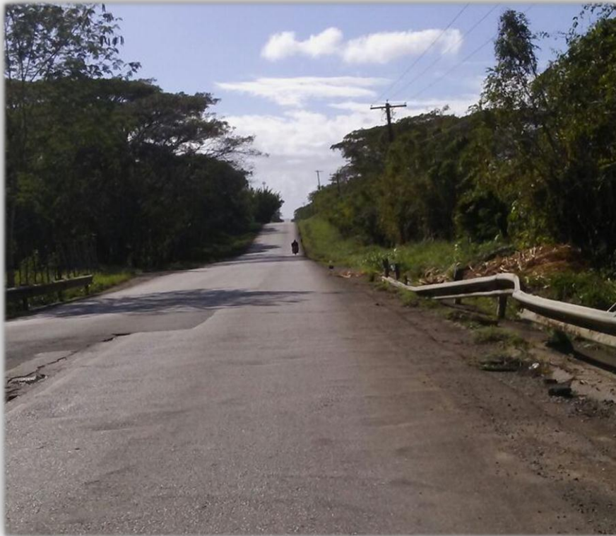
Figura 17. Barrera de contención vehicular sin reparar luego de un accidente en la carretera El Seibo – Hato Mayor.
