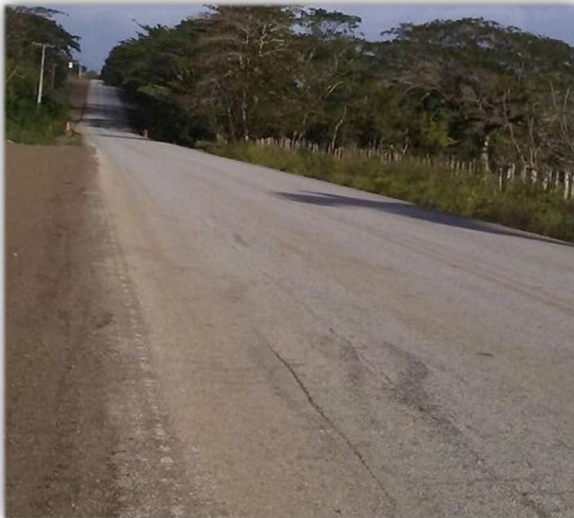
Figura 5. Fisura longitudinal de severidad baja en la carretera El Seibo - Hato Mayor.
