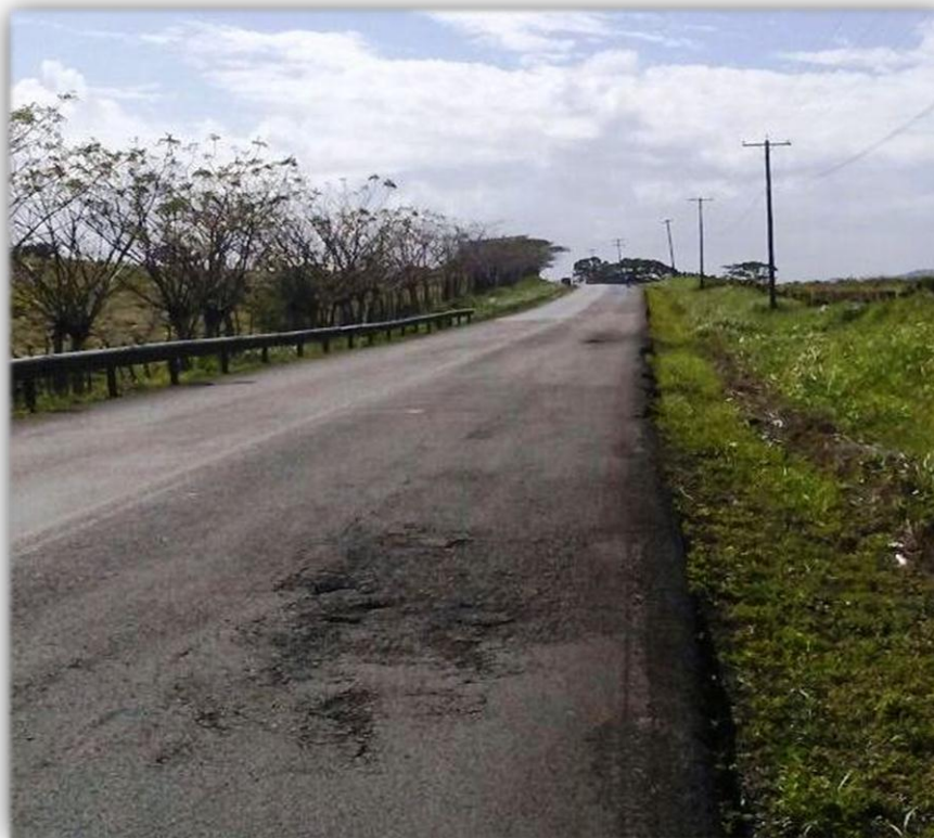
Figura 9. Desintegraciones por peladura en la carretera El Seibo - Hato Mayor.
