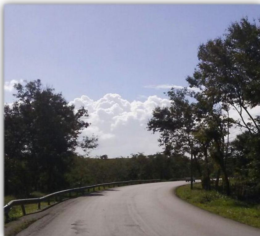
Figura 19. Barrera de contención vehicular en mal estado en una curva horizontal de la carretera El Seibo - Hato Mayor.
