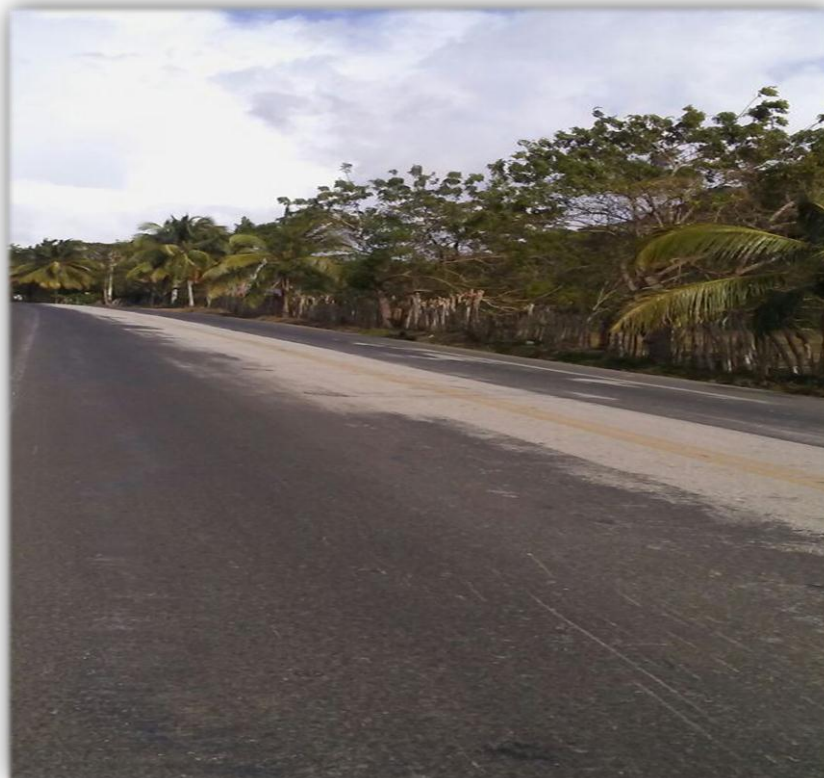
Figura 7. Falla por exudación de asfalto en la carretera El Seibo - Hato Mayor.
