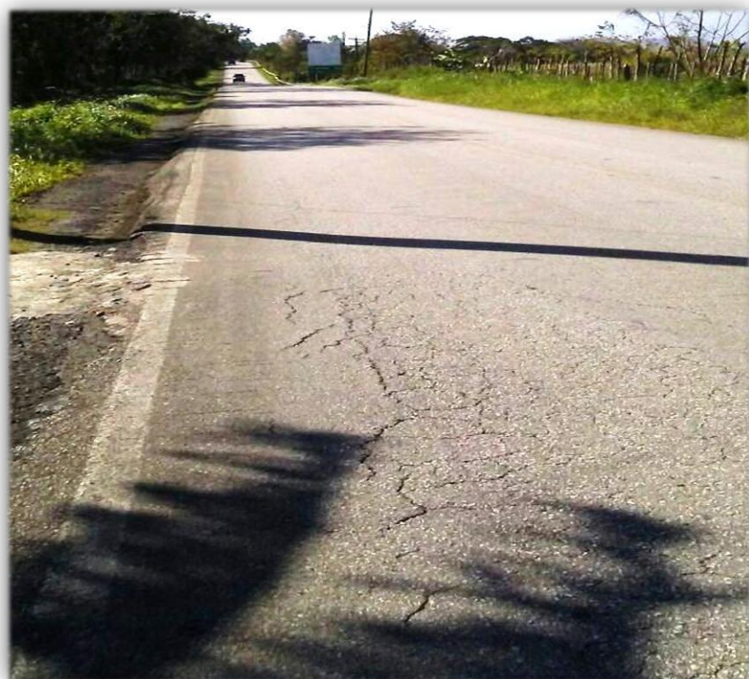
Figura 6. Fisura piel de cocodrilo severidad baja en la carretera El Seibo - Hato Mayor.
