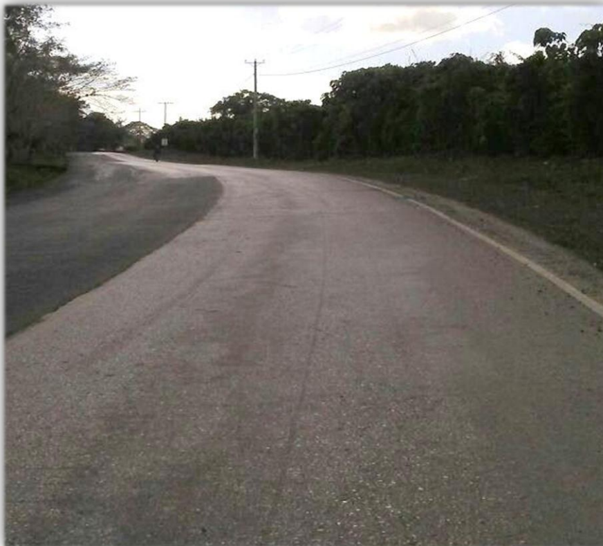
Figura 12. Ausencia de señalización vertical en una curva en la carretera El Seibo - Hato Mayor.
