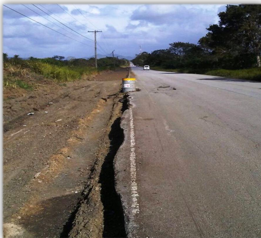
Figura 10. Desintegraciones por rotura de bordes en la carretera El Seibo - Hato Mayor.
