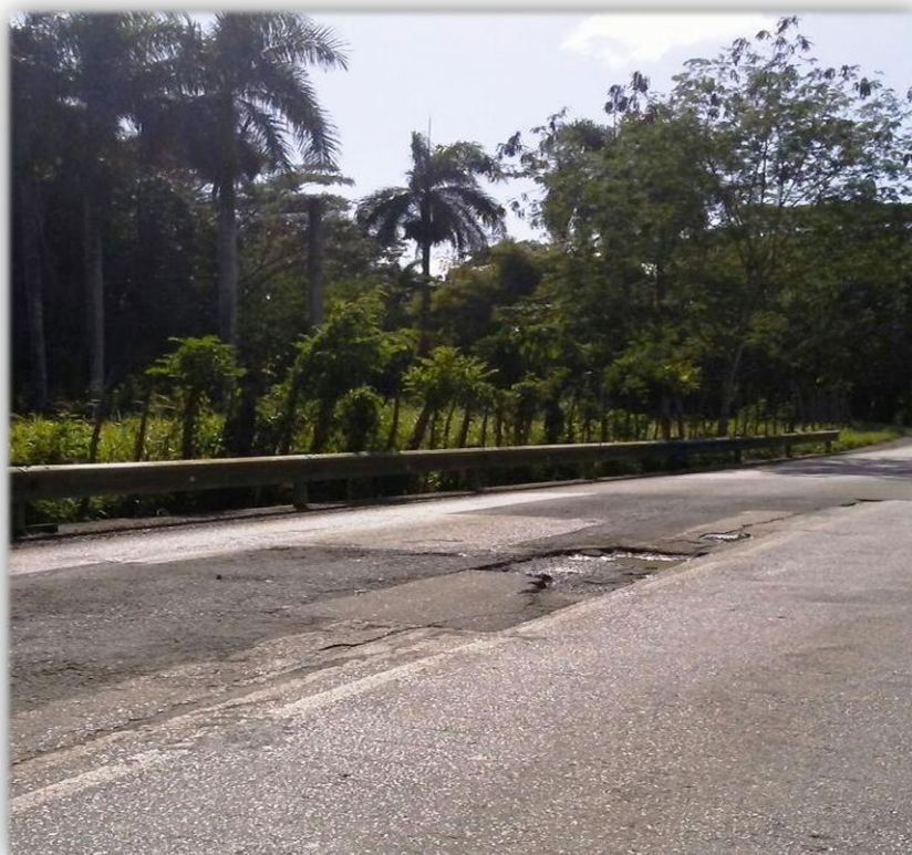
Figura 8. Desintegraciones por baches en la carretera El Seibo - Hato Mayor.
