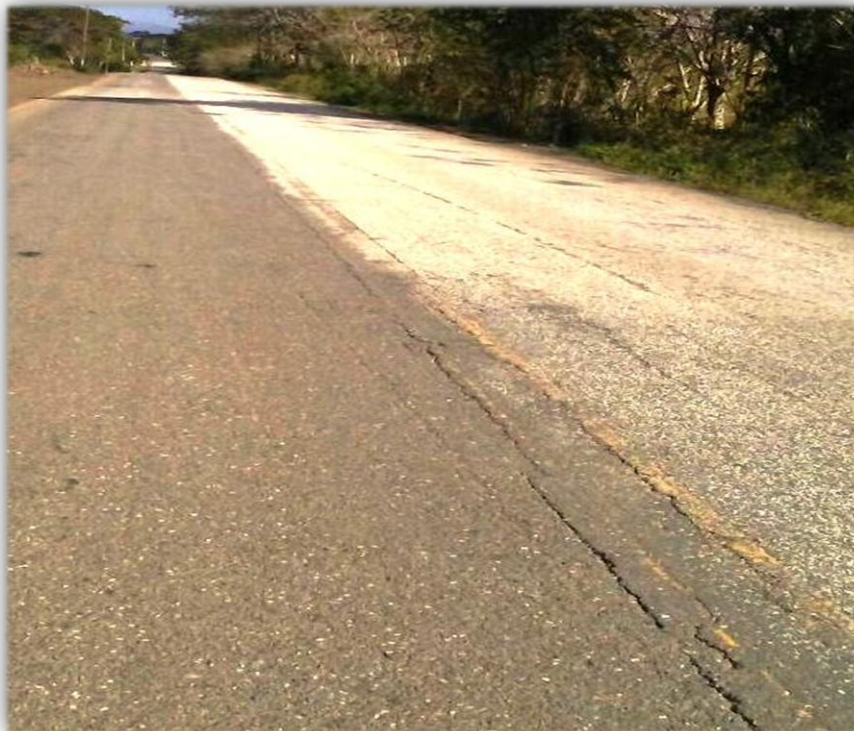
Figura 4. Fisura longitudinal de severidad media en la carretera El Seibo - Hato Mayor.
