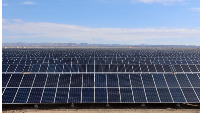
Figura 77. Instalación solar fotovoltaica con módulos Trina Solar TSM-320 PD14
