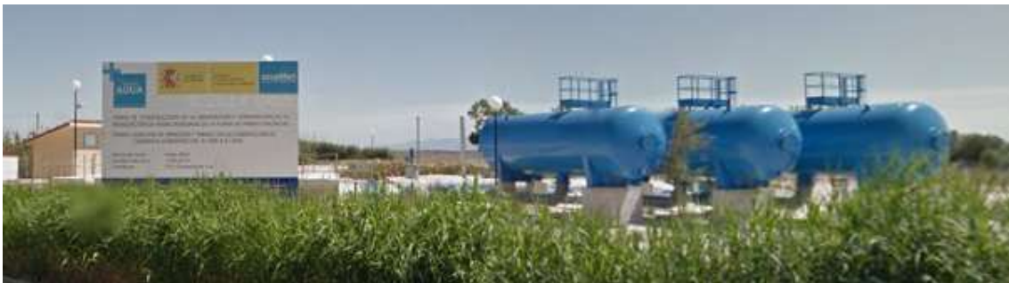
Figura 10. Calderines de la estación de bombeo del Puerto de Catarroja
