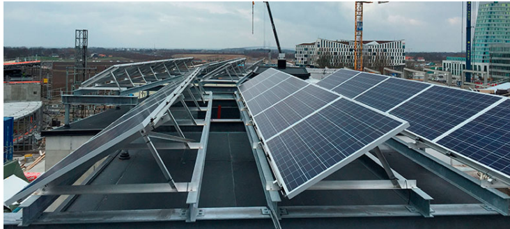
Figura 78. Módulos solares instalados sobre soportes Triangle de K2 Systems
