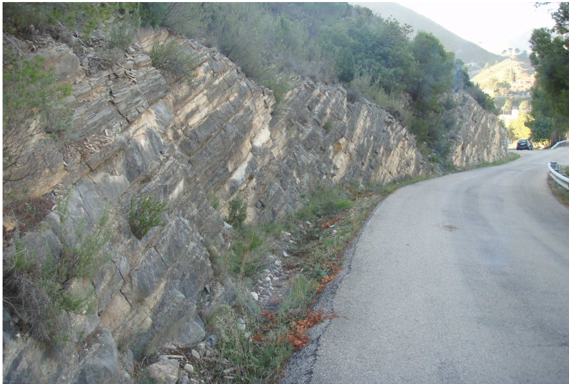
FIGURA – 77: TALUDES EN ROCA DE LA CARRETERA DE ACCESO A LA PRESA DEL EMBALSE DE LORIGUILLA.
