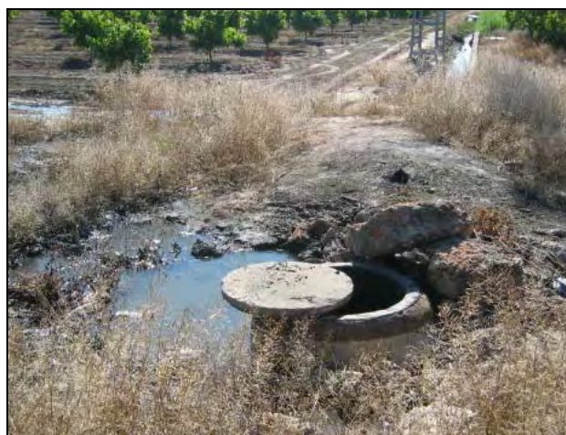
Figura 2-60. Desbordamientos en el pozo nº28, aguas arriba del tramo en contrapendiente.
