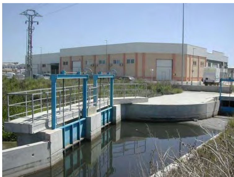
Figura 2-42. Compuertas de vaciado de la balsa junto a Rambleta. Vista un día seco.
