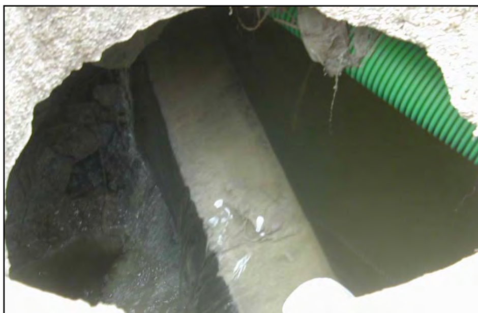
Figura 2-26. Aliviadero junto al restaurante El Puente, funcionando debido a una obstrucción en la conexión con el ramal Sedaví el 9 de julio de 2005
