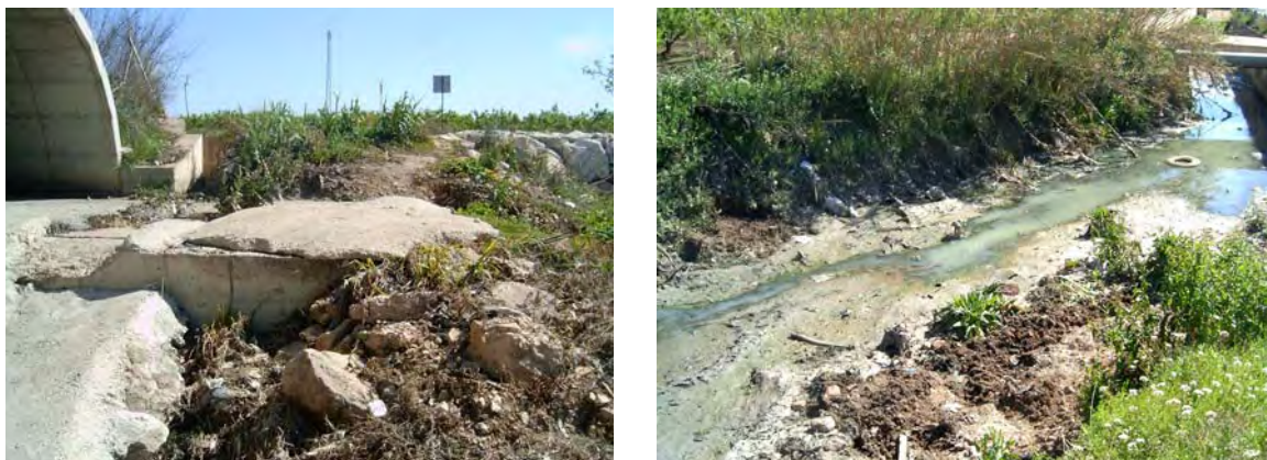
Figura 2-69. Detalle del aliviadero del colector general a la salida del casco urbano de Alginet (izq.). Detalle de la contaminación en el Barranco de Algadins, aguas abajo del cruce con la acequia Real del Júcar (dcha.). Imágenes de abril 2005. Fuente: archivo Tyspa
