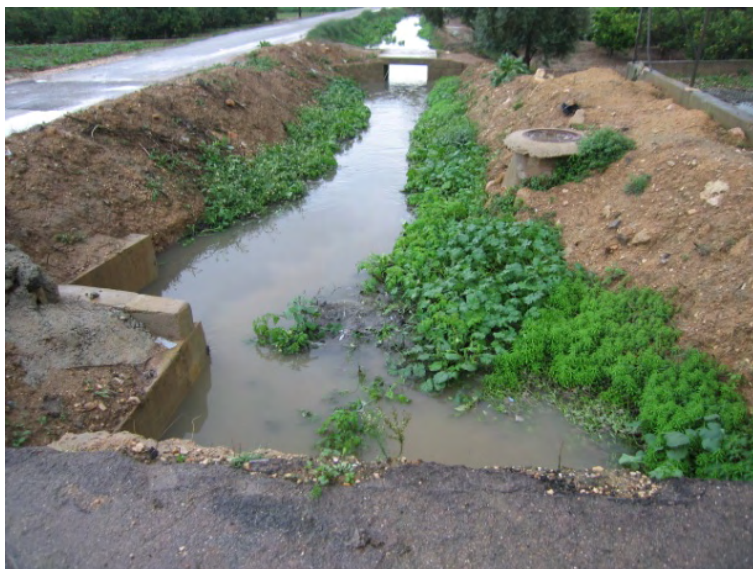
Figura 2-67. Surgencia de aguas fecales en la acequia de la Font del Alter
