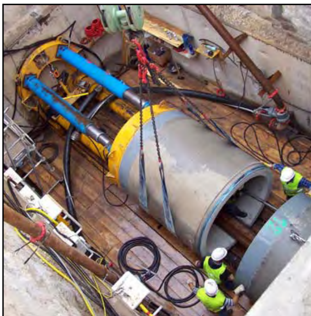
Figura 2-21. Obras de Reutilización Aguas Residuales de la E.D.A.R. de Pinedo (Generalitat Valenciana). Cruce del Nuevo Cauce del Turia. Fuente: (Romymar, S.A., 2007)
