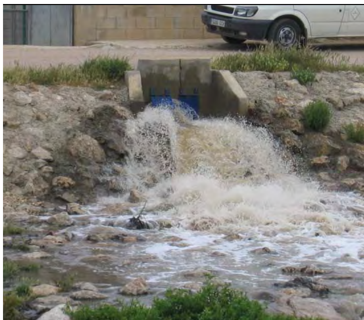
Figura 2-58. Aliviadero de la estación de bombeo de Beniparrell en funcionamiento el día 17 de mayo de 2005.
