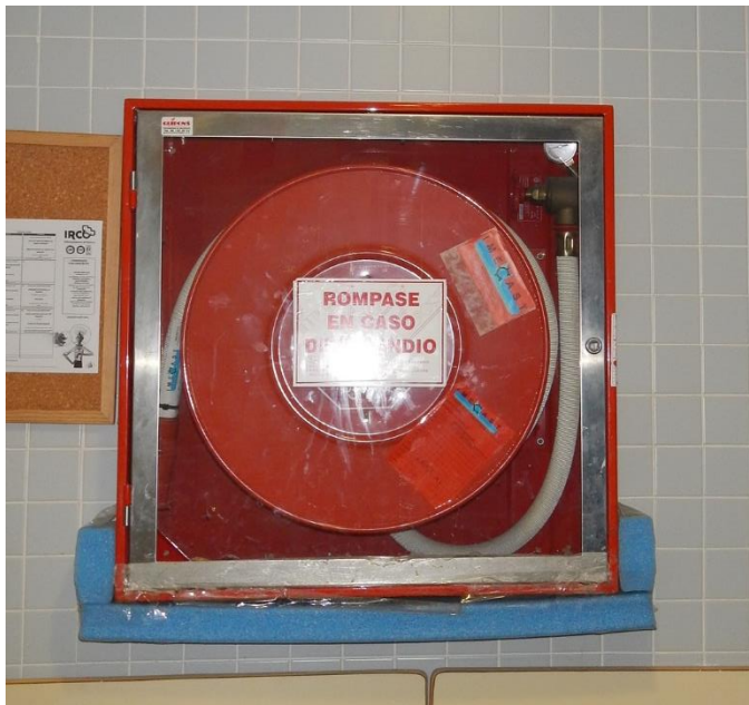
FIGURA 76. BOCA DE INCENDIO EQUIPADA
