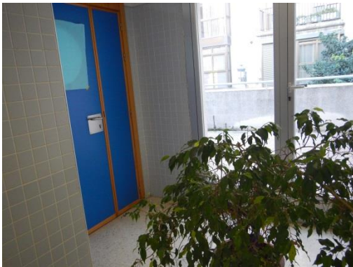
FIGURA 9. MACETERO BLOQUEANDO SALIDA SR.P.46 DEL AULA DE MÚSICA, ACTUALMENTE EN DESUSO
