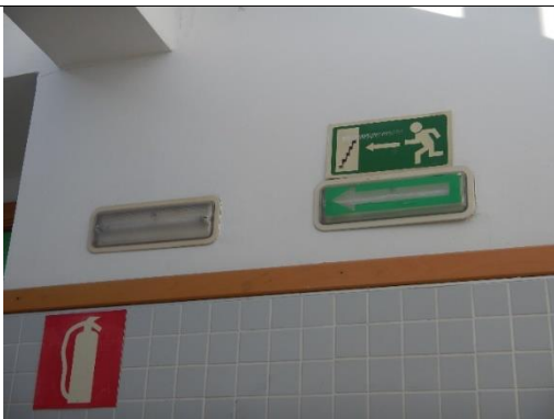
FIGURA 87. SEÑALIZACIÓN DE RECORRIDO DE EVACUACIÓN CON RÓTULO Y ALUMBRADO DE SEÑALIZACIÓN
