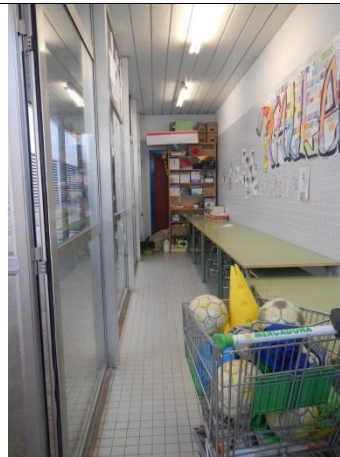
FIGURA 12. SALIDA EN PASILLO DE EDIFICIO SECUNDARIO, SR.S. 4, ACTUALMENTE BLOQUEADA
