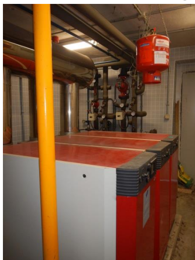
FIGURA 53. VISTA GENERAL DE SALA DE CALDERAS Y EXTINTOR AUTOMÁTICO COLGADO
