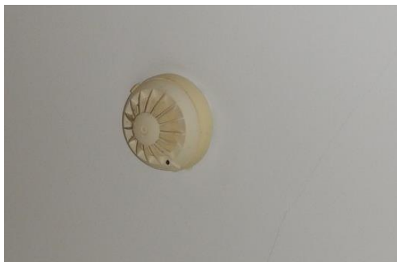
FIGURA 66. DETECTOR DE HUMOS EN TECHO DE COCINA
