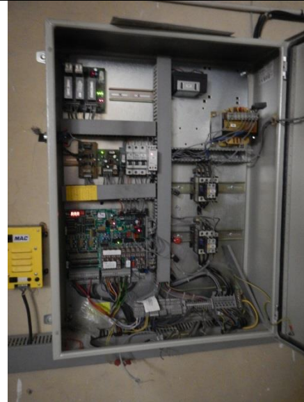
FIGURA 40. CUADRO SECUNDARIO ASCENSORES
