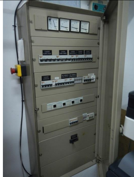
FIGURA 35. CUADRO GENERAL DE BAJA TENSIÓN
