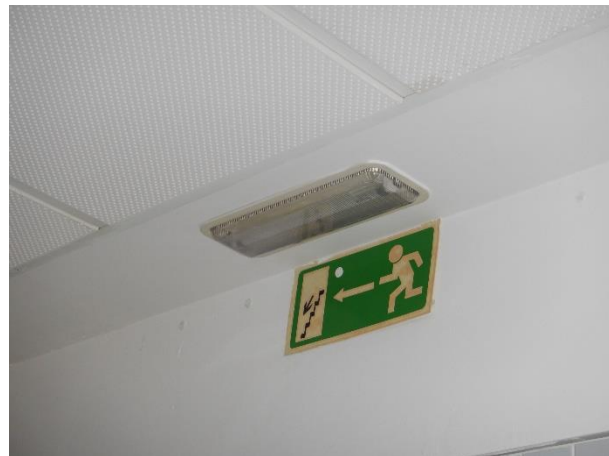
FIGURA 86. ALUMBRADO DE EMERGENCIA EN PASILLO
