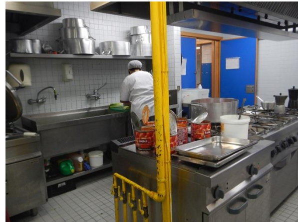
FIGURA 48. LLAVES DE CORTE DE GAS POR APARATO DE COCINA
