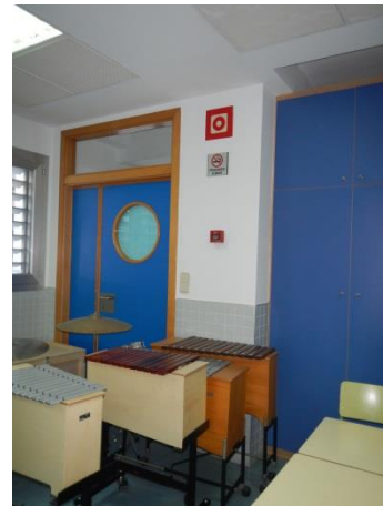
FIGURA 10. INSTRUMENTO MUSICALES BLOQUEANDO SALIDA SR.P.46 DEL AULA DE MÚSICA, ACTUALMENTE EN DESUSO
