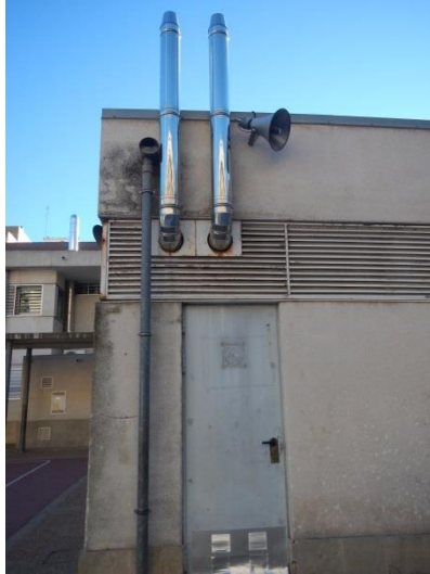
FIGURA 61. EXTERIOR SALA CALDERA GIMNASIO
