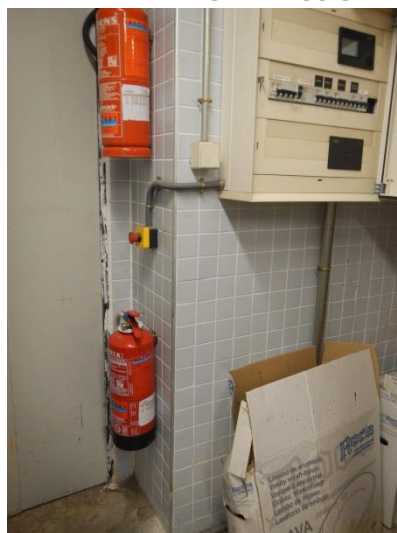
FIGURA 54. EXTINTORES PORTÁTILES DE POLVO Y PULSADOR MANUAL DE PARADA DE CALDERA
