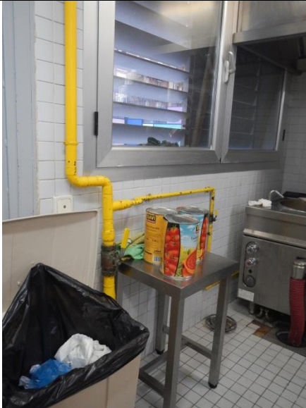
FIGURA 47. LLAVE GENERAL DE GAS EN COCINA
