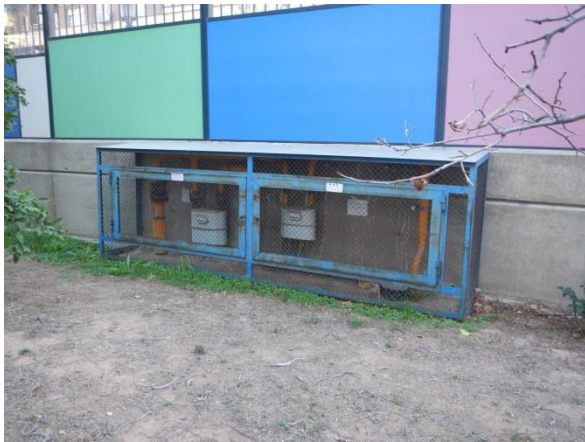
FIGURA 45. ACOMETIDA Y CONTADORES DE GAS
