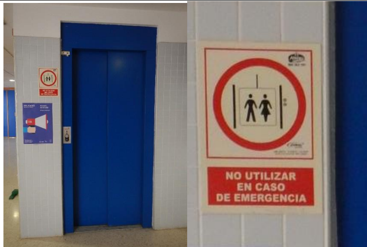
FIGURA 83. SEÑALIZACIÓN DE ASCENSOR
