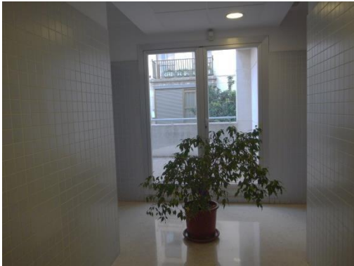
FIGURA 7. MACETERO EN EXTREMO SUR DE PASILLO DE PLANTA PRIMERA EP, BLOQUEANDO SEGUNDAS SALIDAS DE AULA DE INFORMÁTICA Y DE MÚSICA
