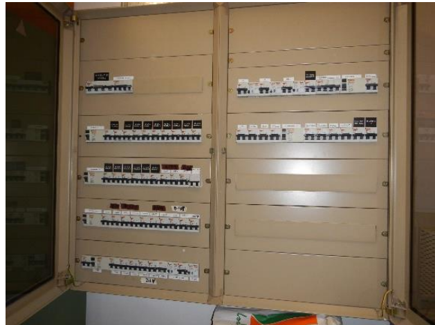
CUADRO SECUNDARIO DE PLANTA PRIMERA INSTALADO EN ALMACÉN DE PLANTA PRIMERA
