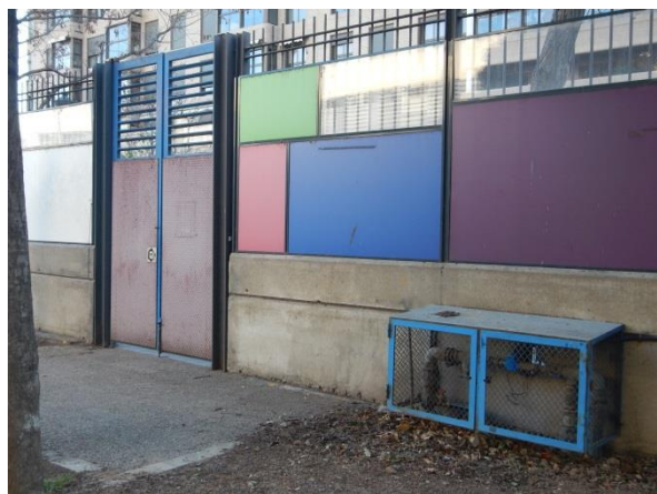
FIGURA 43. ACOMETIDA DE AGUA POTABLE
