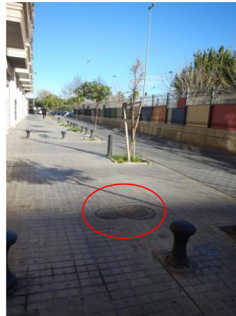
FIGURA 11. VISTA DEL HIDRANTE SITUADO AL OESTE DE LA PARCELA DEL CENTRO
