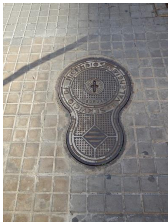
FIGURA 77. HIDRANTE DE INCENDIO
