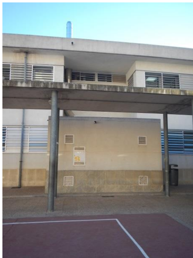
FIGURA 50. SALA CALDERAS PARA CALEFACCIÓN
