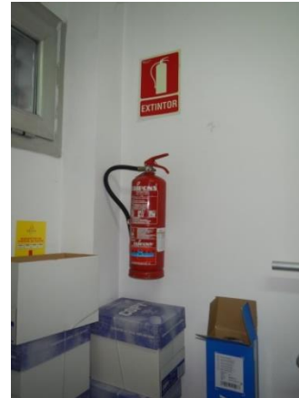
FIGURA 56. EXTINTOR DE SALA DE REPROGRAFÍA
