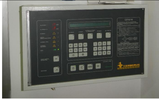
FIGURA 69. CENTRAL DE DETECCIÓN INSTALADA EN CONSERJERÍA
