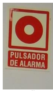
FIGURA 82. SEÑALIZACIÓN PULSADOR DE ALARMA
