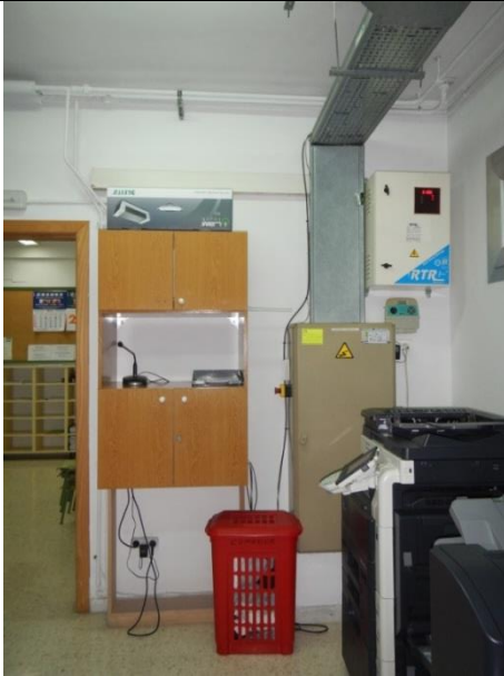
FIGURA 34. CUADRO GENERAL BAJA TENSIÓN
