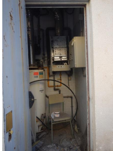
FIGURA 62. INTERIOR SALA CALDERA GIMNASIO
