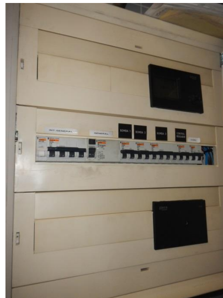
FIGURA 42. CUADRO TERCIARIO CALEFACCION
