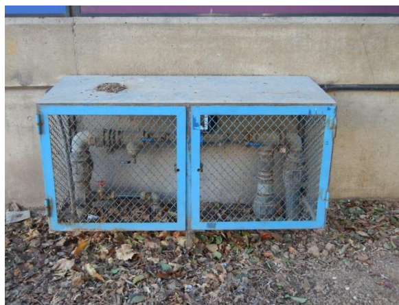
FIGURA 44. ACOMETIDA Y CONTADOR DE AGUA POTABLE
