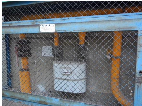
FIGURA 46. LLAVE GENERAL Y CONTADOR DE GAS
