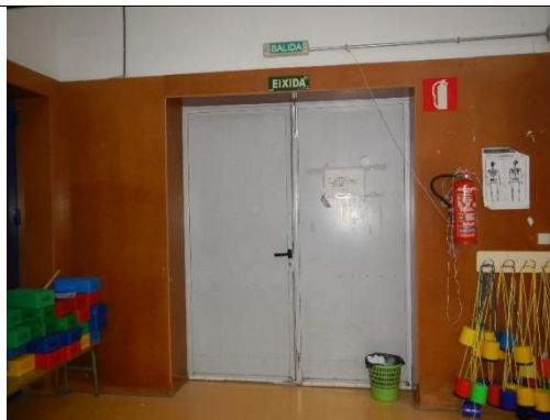
FIGURA 88. SEÑALIZACIÓN DE SALIDA DE LOCAL CON RÓTULO Y ALUMBRADO DE SEÑALIZACIÓN
