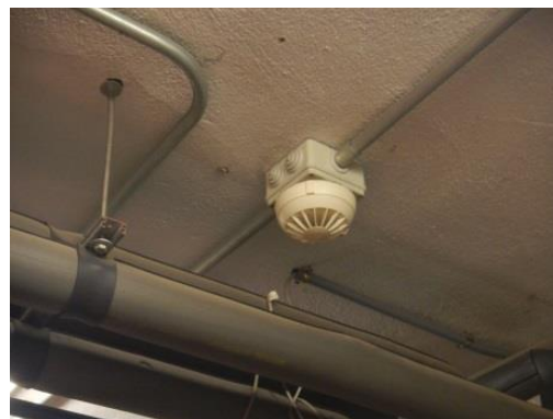
FIGURA 67. DETECTOR DE HUMOS EN SALA DE CALDERAS
