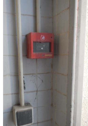
FIGURA 63. PULSADOR ALARMA ROTO EN SALA CALDERA GIMNASIO
