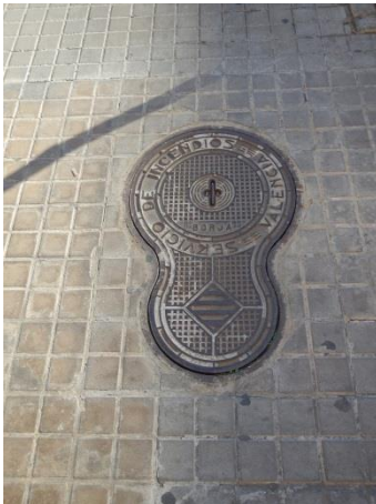
FIGURA 10. HIDRANTE DE INCENDIO
