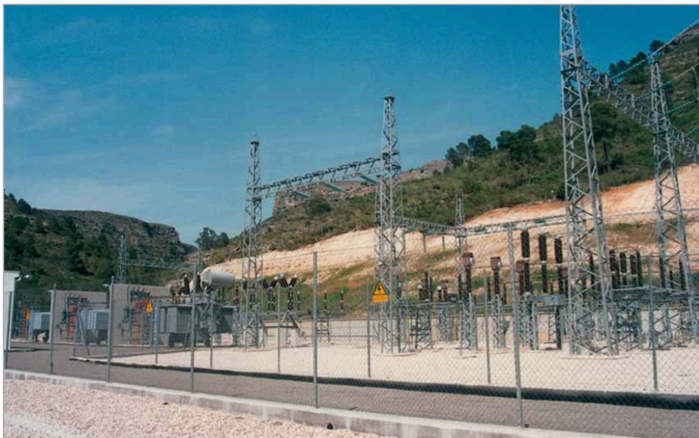
Imagen 18: Subestación de transformación. Equipos de transformación y potencia. Libro La presa de Tous.
