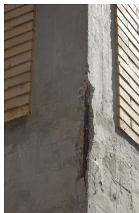
Foto nº2.- Desconche en pilar de fachada.
