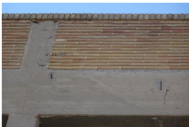
Foto nº1.- Fisuras en viga de fachada.
