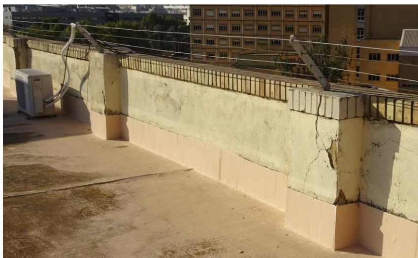
Foto nº4.- Falta de conexión y daños en pilastras de peto de cubierta.
