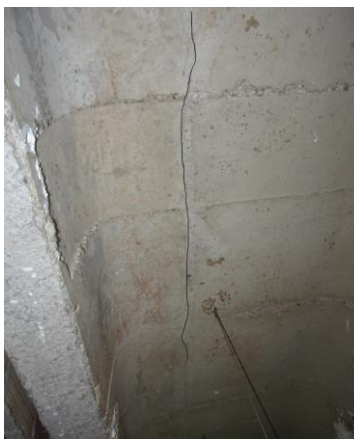
Foto nº3.- Fisura en cara inferior de forjado.
