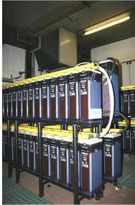
Figura 19: Estructura de las baterías.
