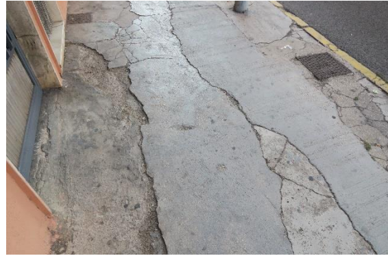
Fotografía 19 Estado del pavimento. Ejemplo 4
