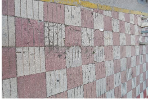
Fotografía 18 Estado de conservación del pavimento. Ejemplo 3
