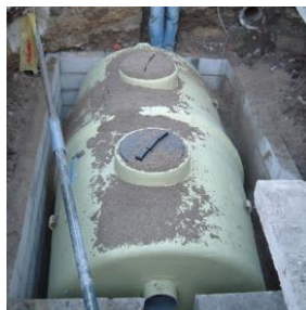
Separador de grasas y fangos [58]
