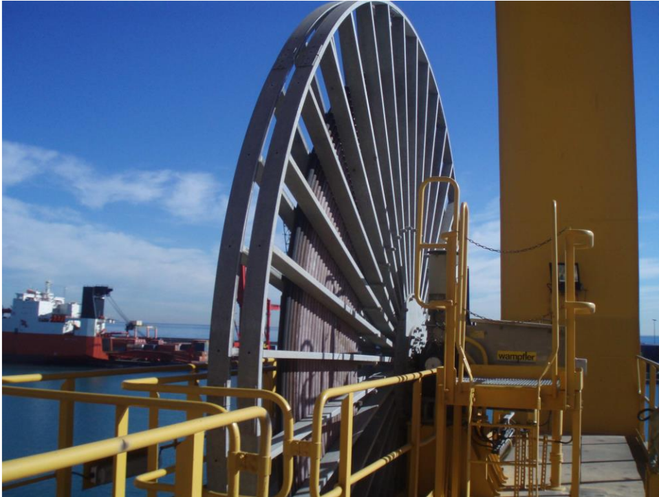
Ilustración 14. Enrollador cable alimentación grúa
